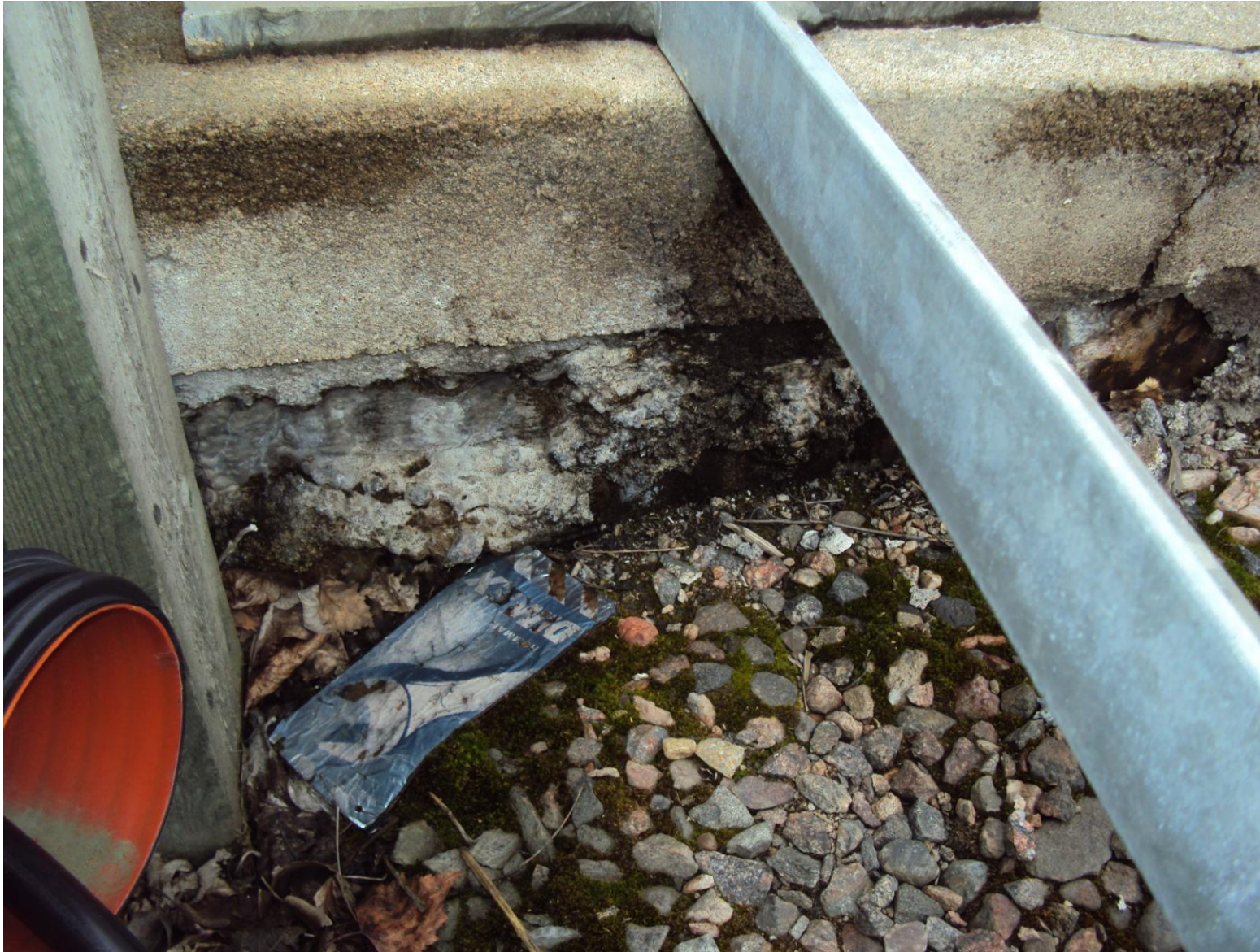
Liite 4 Perustuksen rapautumista ja maan sammaloitumista (TVO)
