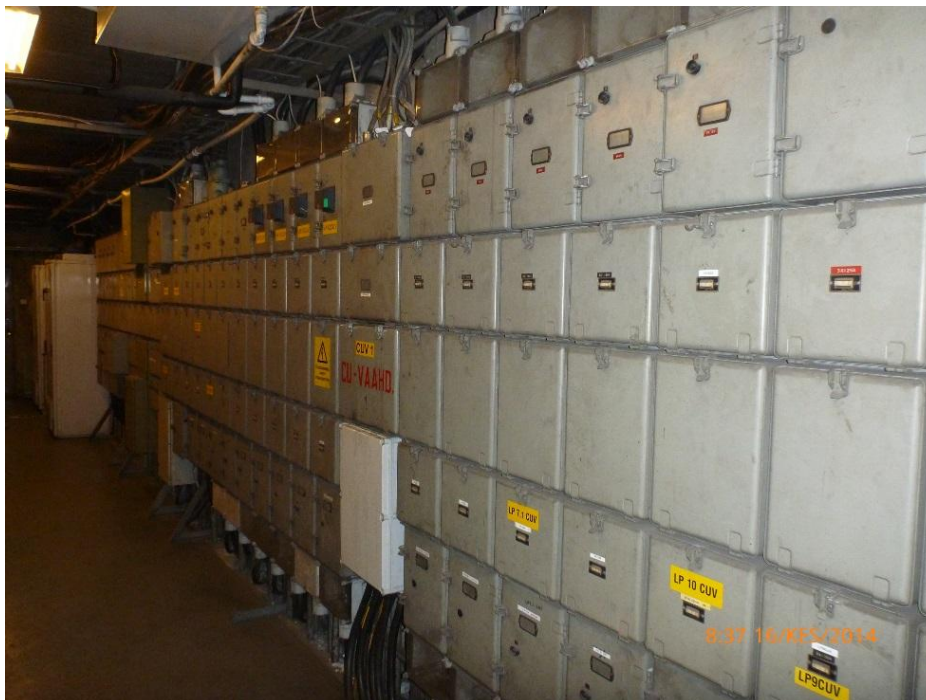
KUVA 18 Sähkökeskuksen seinämä (Hakkarainen 2014.)
