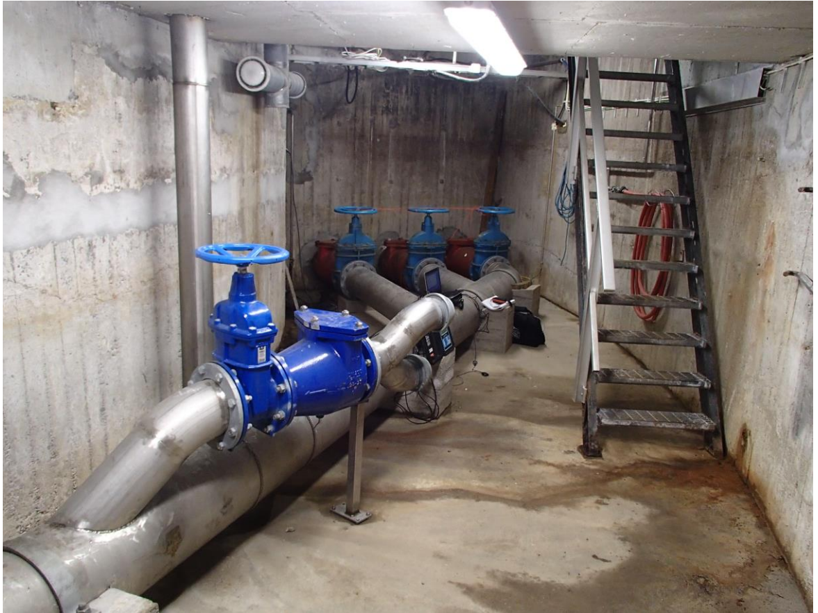
Kuva 5. Espoon pumppaamon huoltotila
