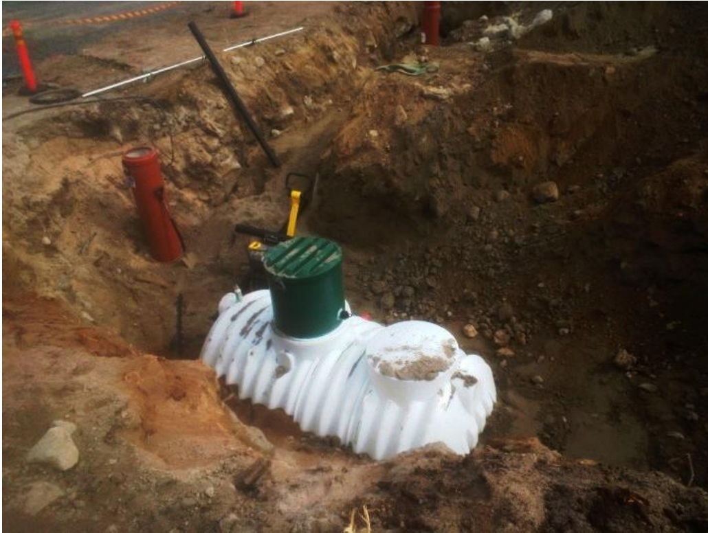
KUVA 3. Hulevesien viivytys- ja varastointisäiliö
