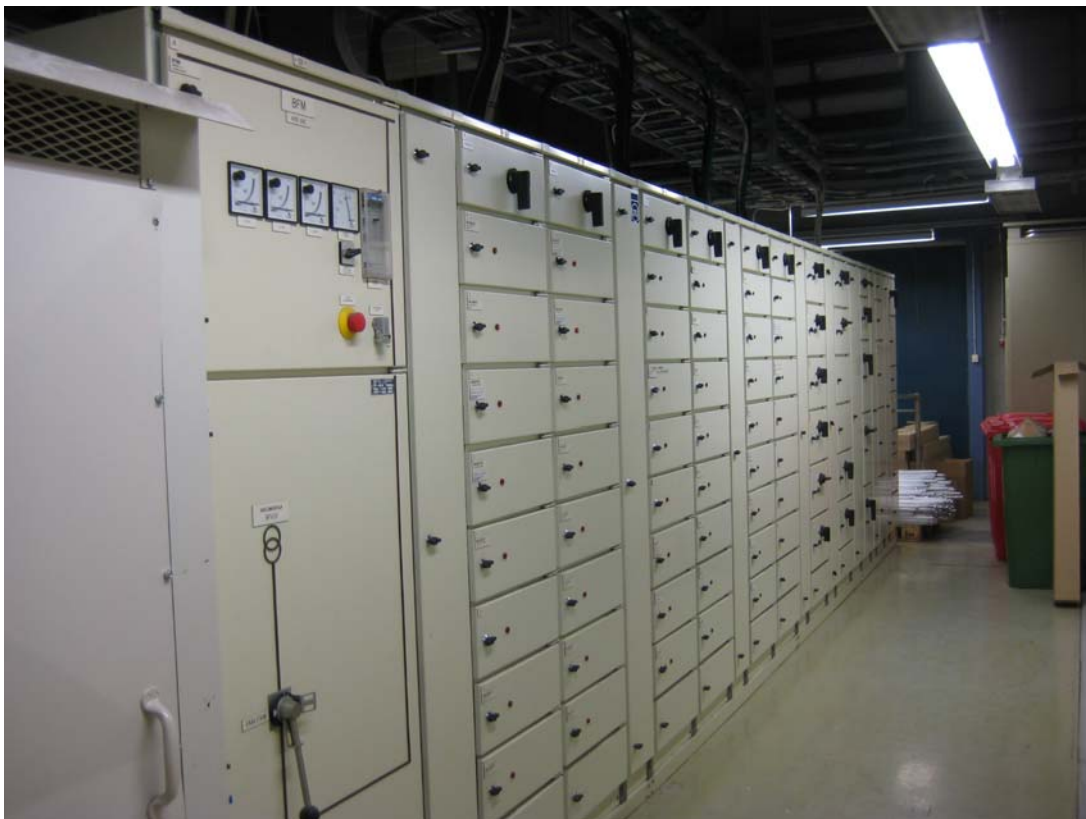
Kuva 3. Rikinpoistolaitoksen prosessisähkökeskus (Kekkonen 2014).
