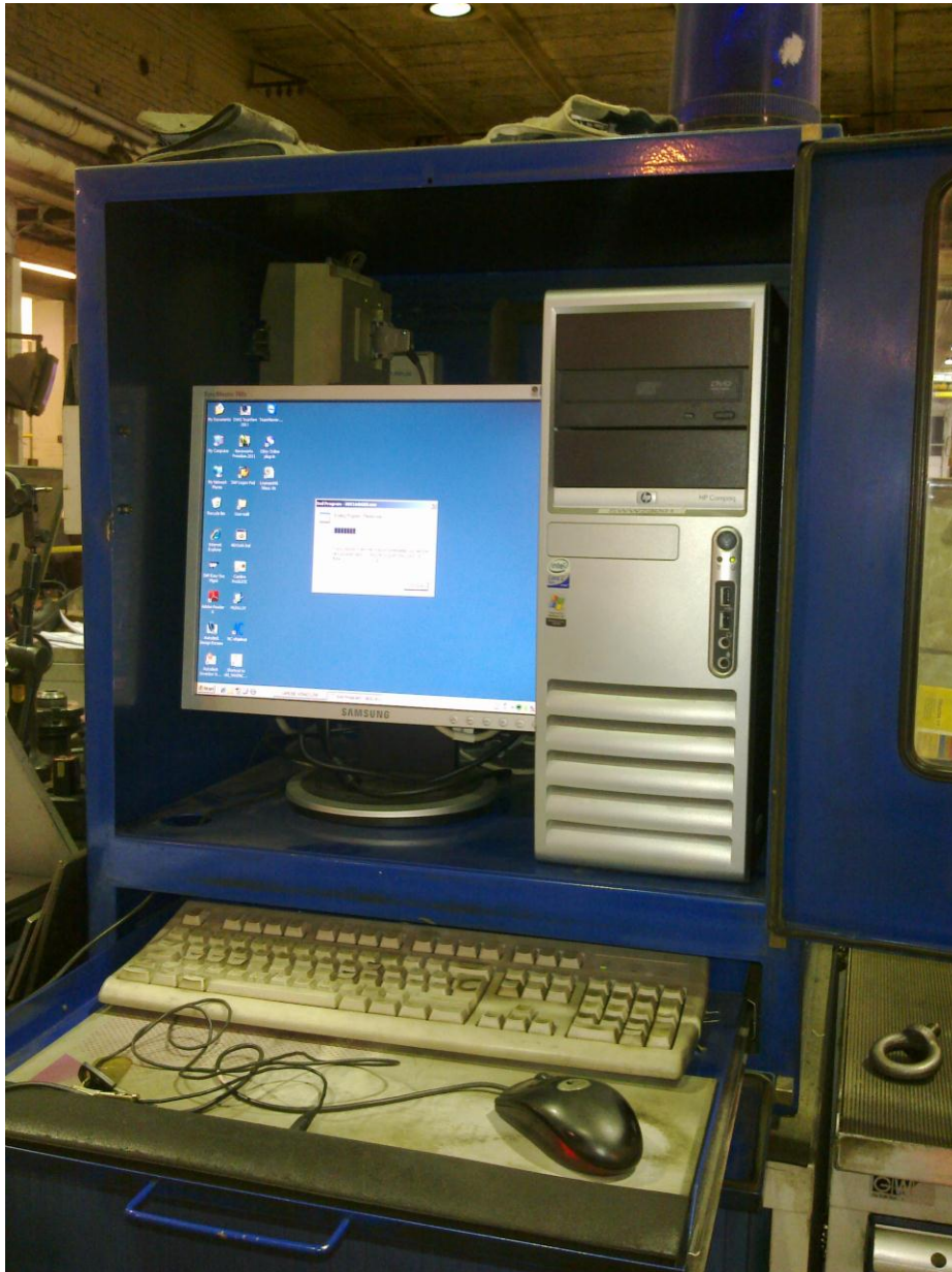
Kuva 20. Laitekaappi. Useissa kaapeissa laitteet olivat erittäin ahtaalla.
