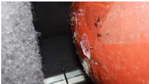
Kuva 30. Kaasusäiliön päädyssä havaittiin vuoto. Vuotokohtaan suikutettiin vesi-pesuaineseosta. Säiliö vaihdettiin välittömästi.
