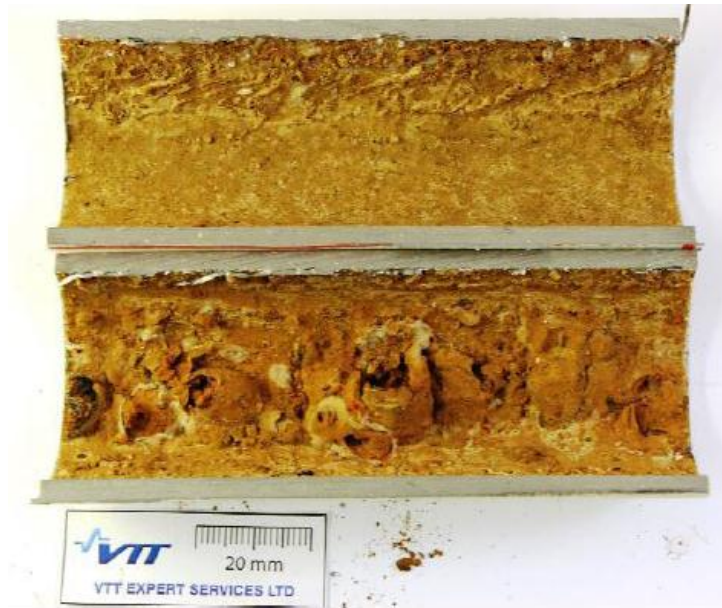
Kuva 8. Putken sisäpinta. Vuotokohta putken alemmalla puoliskolla. (9)
