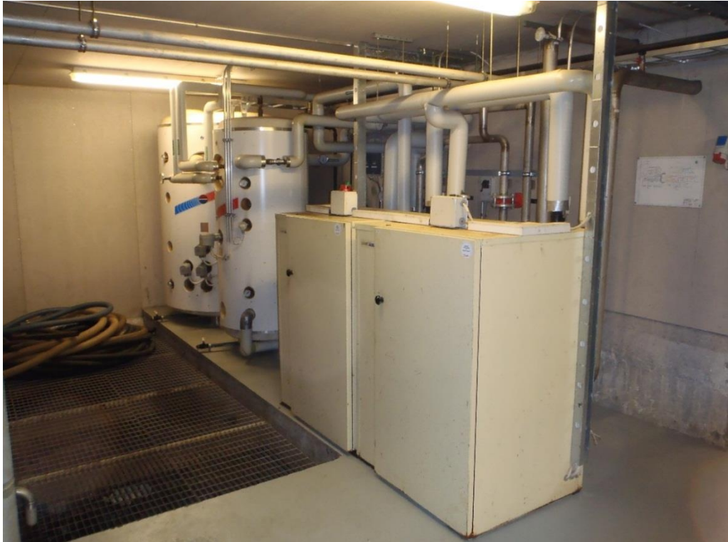
KUVA 14. Kiteen keskustaajaman puhdistamon lämpöpumput ja varaajat
