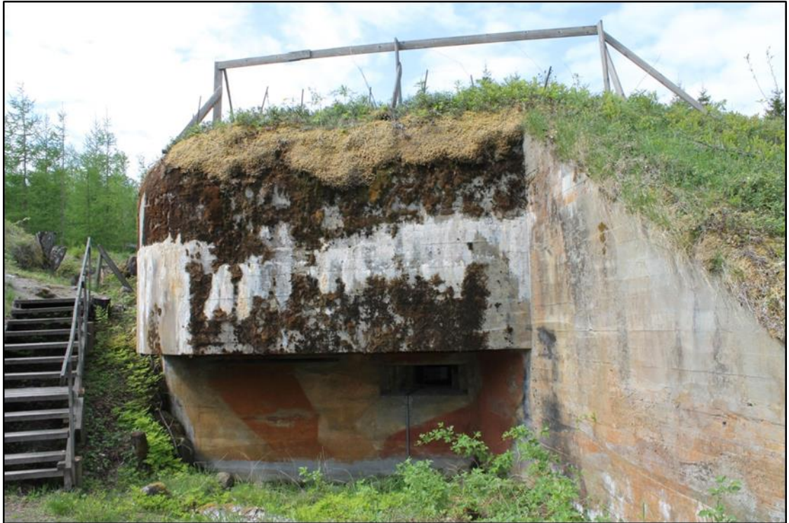
KUVA 17. Korsun nro 63 ampuma-aukon päältä pudotusta maahan on noin 5 metriä. Kuvassa näkyy myös korsujen päällä olevia terästappeja; näihin kompassuissa huonokuntoinen ja osittain alustastaan irti oleva kaide ei suojele vierailijaa.
