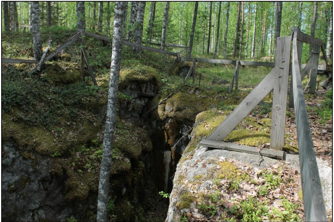
KUVA 20. Korsu nro 65 on reitin kauimmainen kohde. Vaikeakulkuisessa maastossa liikkuvan vierailijan ja kuuden metrin pudotuksen välissä on huonokuntoiset kaiteet.
