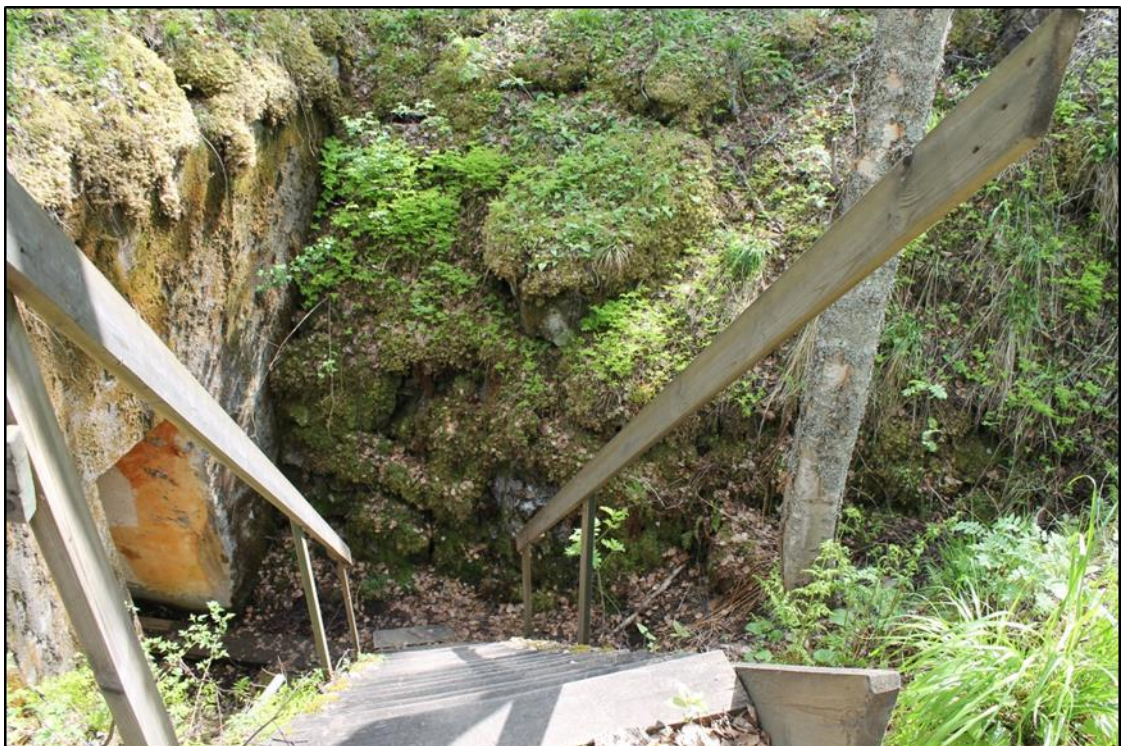
KUVA 19. Korsun nro 64 sisäänkäynnille johtavat portaat. Toukokuussa 2013 käsijohteesta puuttui yläpuolinen pystytuki, lokakuussa koko käsijohde oli romahtanut.
