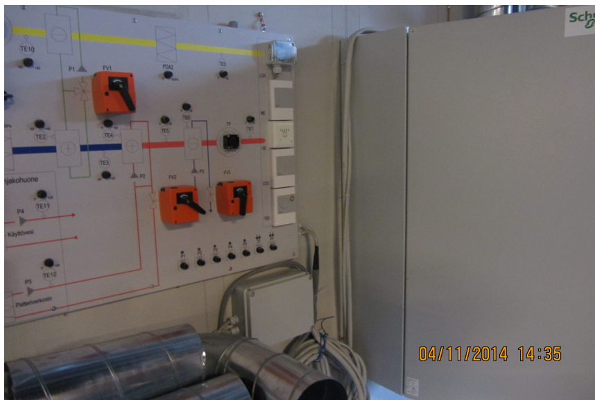
Kuva 28. Kiinteistön automaatiojärjestelmän havainnollistamiseen ja toiminnan tutkimiseen käytettävä opetuspiste
