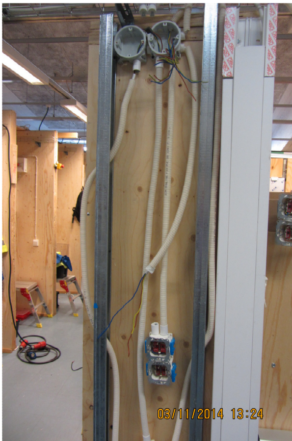
Kuva 18. Keskenäinen valaisinkytkentä rakenteessa
