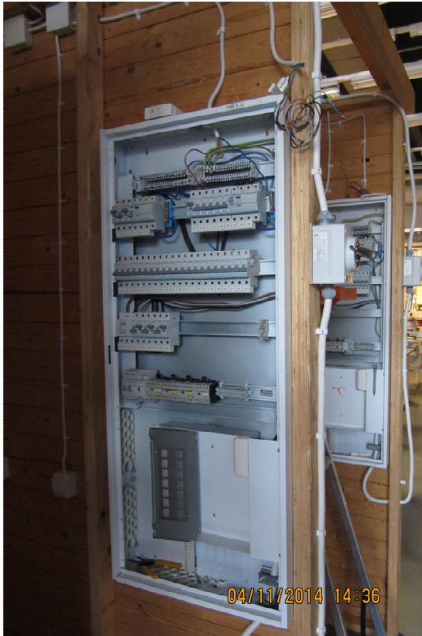
Kuva 16. Ryhmäkeskus ja sen syöttö varustettuna lukittavalla turvakytkimellä
