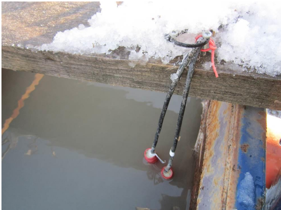
Kuva 15. Automatisoidun pH-laitteiston anturit
