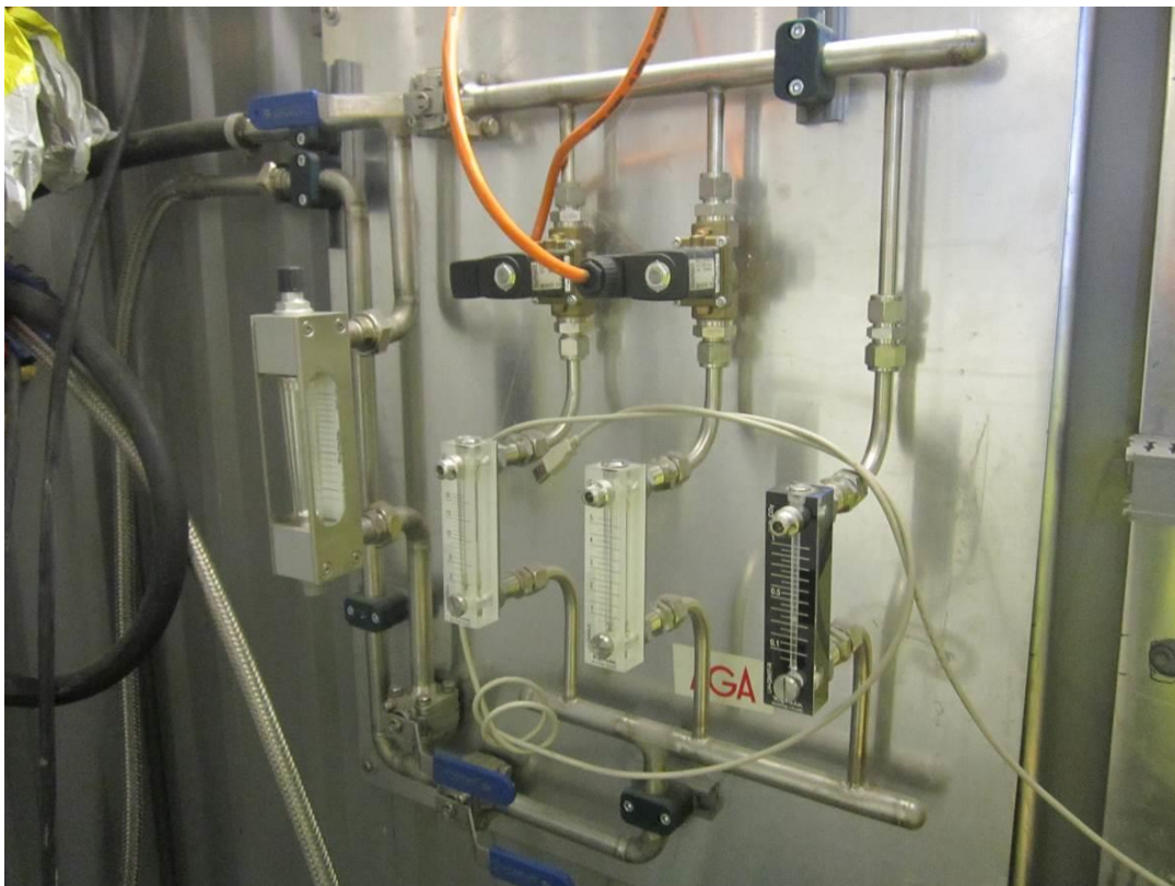
Kuva 17. Automatisoidun pH-laitteiston syöttöputkisto säätimillä
