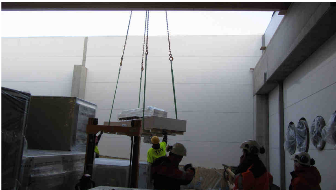
Kuva 5. Nostotyö vesikatolla sijaitsevaan iv-konehuoneeseen sisältä kuvattuna. Kattoelementit poistettiin paikoiltaan, jolloin mahdollistui kappaleiden nosto ajoneuvonosturilla suoraan kohteeseen. (Leinonen 2012.)
