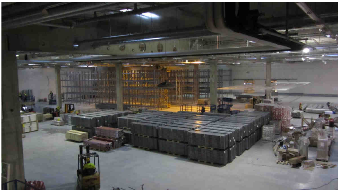
Kuva 24. Korkean varaston osa-alue luovutettu ja alirakoitsijan materiaalien siirto käynnissä alueen tyhjentämiseksi. (Peab Oy 2012.)
