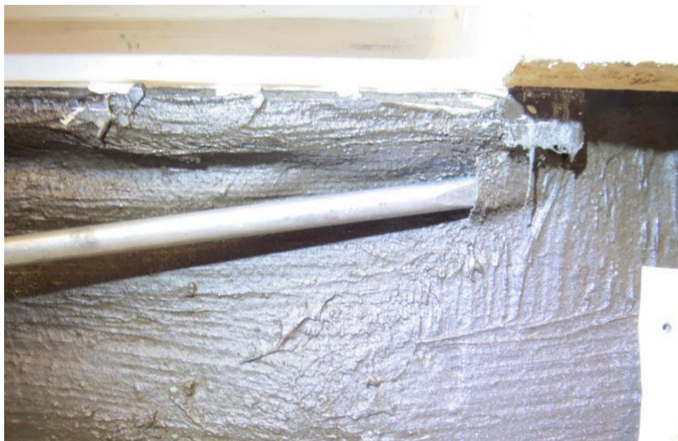
Kuva 27. Tiivistys on irti alustastaan.
