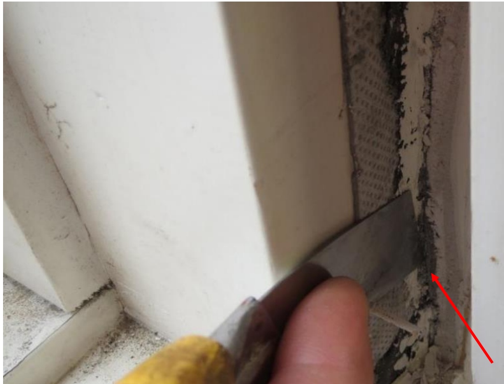
Kuva 25. Peitelistan rikkoma tiivistysnauha.
