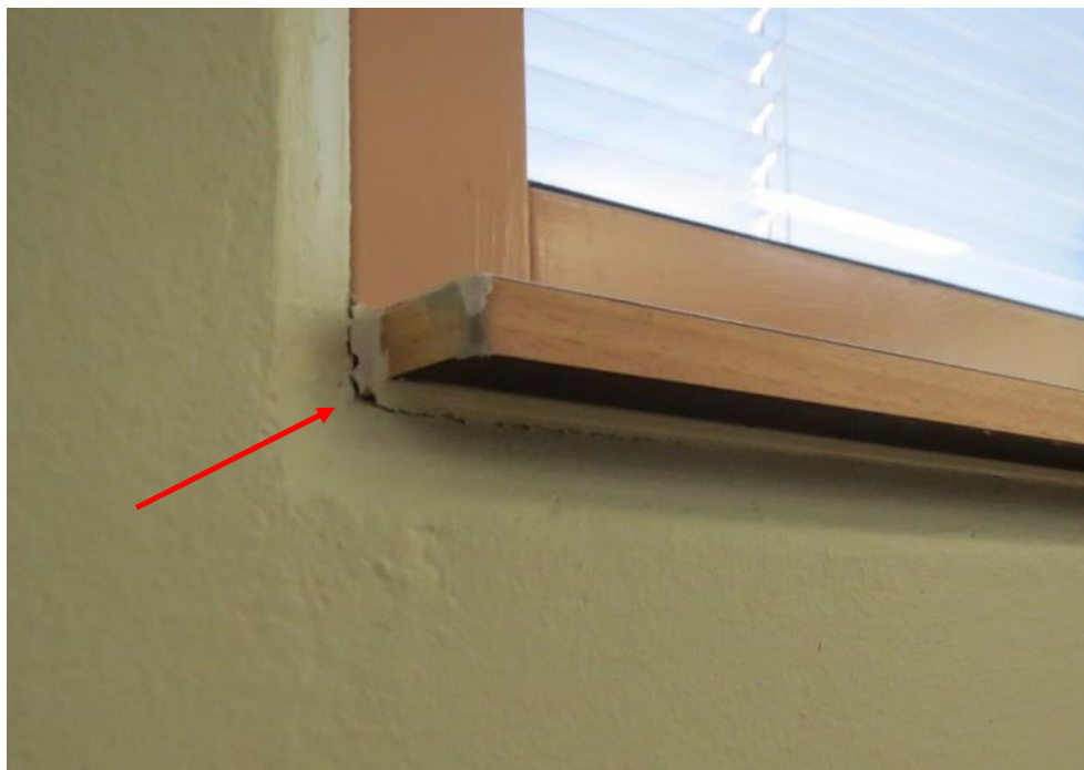
Kuva 22. Kiinteistökerroksella havaittu epätiivis tiivistys.
