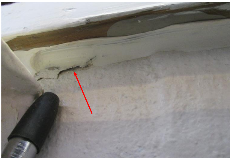
Kuva 19. Epätiivis tiivistys, ikkunan alapuolinen lauta.
