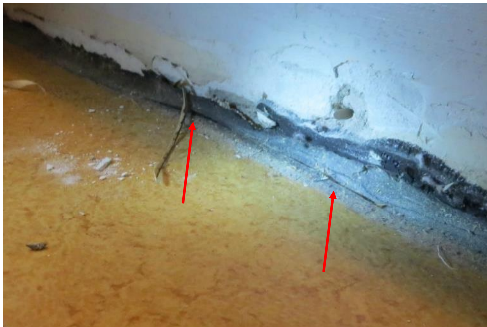
Kuva 18. Epätiivistä tiivistystyötä, alapohjan ja ulkoseinän liittymä.
