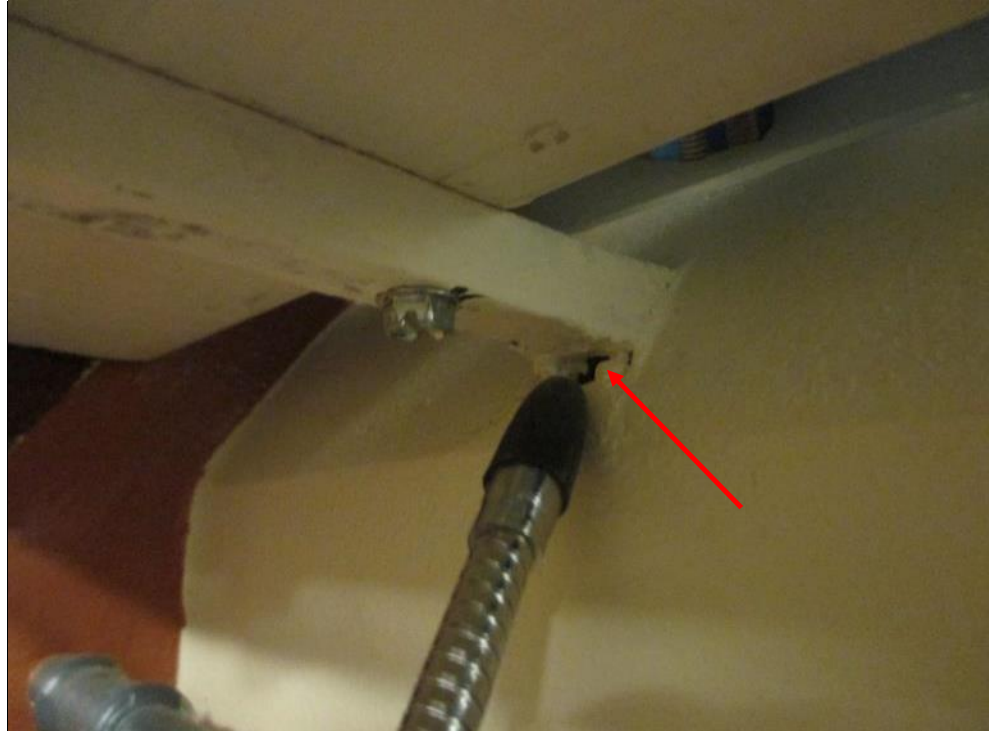
Kuva 21. Ikkunalaudan kiinnikkeen juuressa oleva kolo, josta ilmeni vuoto.
