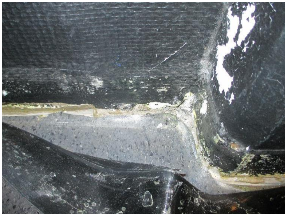
Kuva 24. Alapohjan ja ulkoseinän vuotava liittymä. Tiivistystä ei ole tehty suunnitelmien mukaisesti, Ardex 8+9 -vedeneriste puuttuu.
