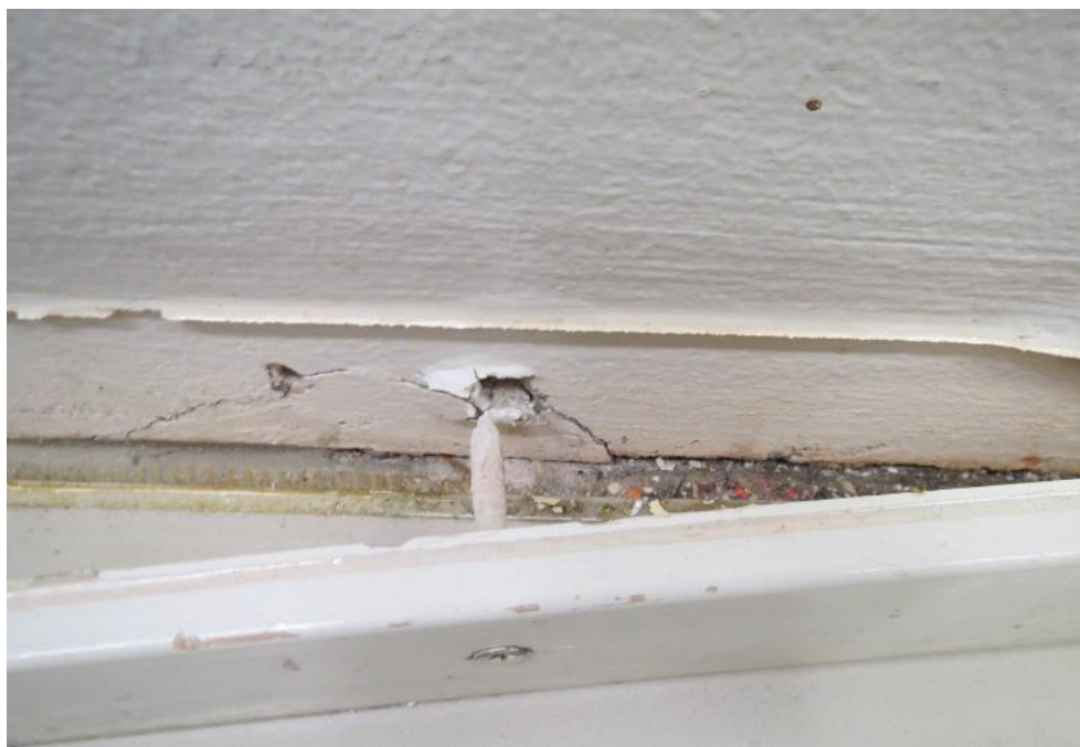
Kuva 20. Alapohjan ja ulkoseinän tiivistetty liitos, jonka listan kiinnitys on rikkonut.
