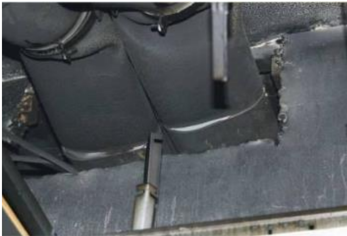
Kuva 17. Palon leviämisen syy alakaton yläpuolella
