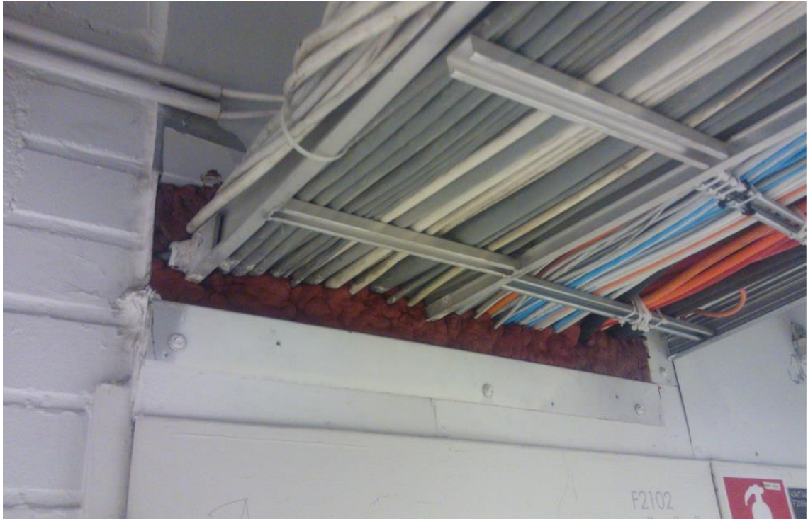
Kuva 12. Vanhaa ja uutta sähkötekniikkaa. Vanhaan aukkoon on tehty siistit läpivienti ympärys.
