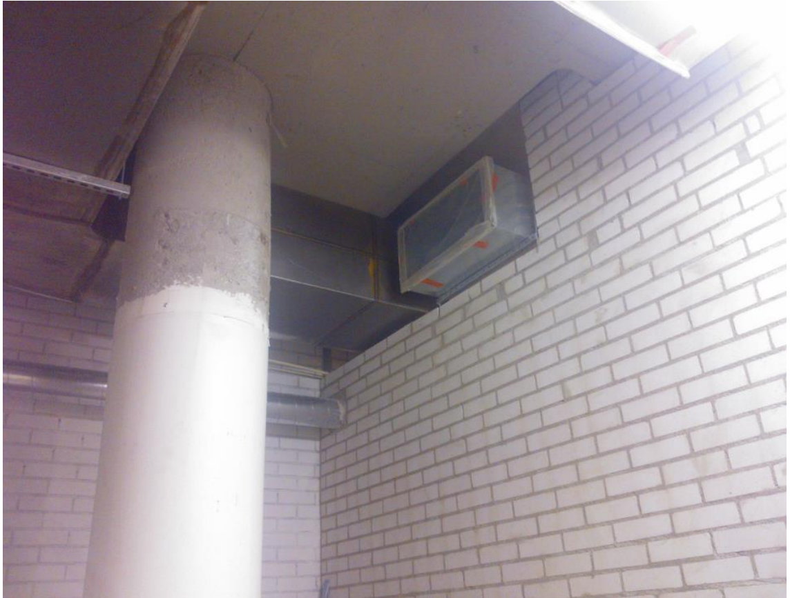
Kuva 6. Kuvassa on ilmanvaihtokanava jätetty seinän päältä jatkamatta
