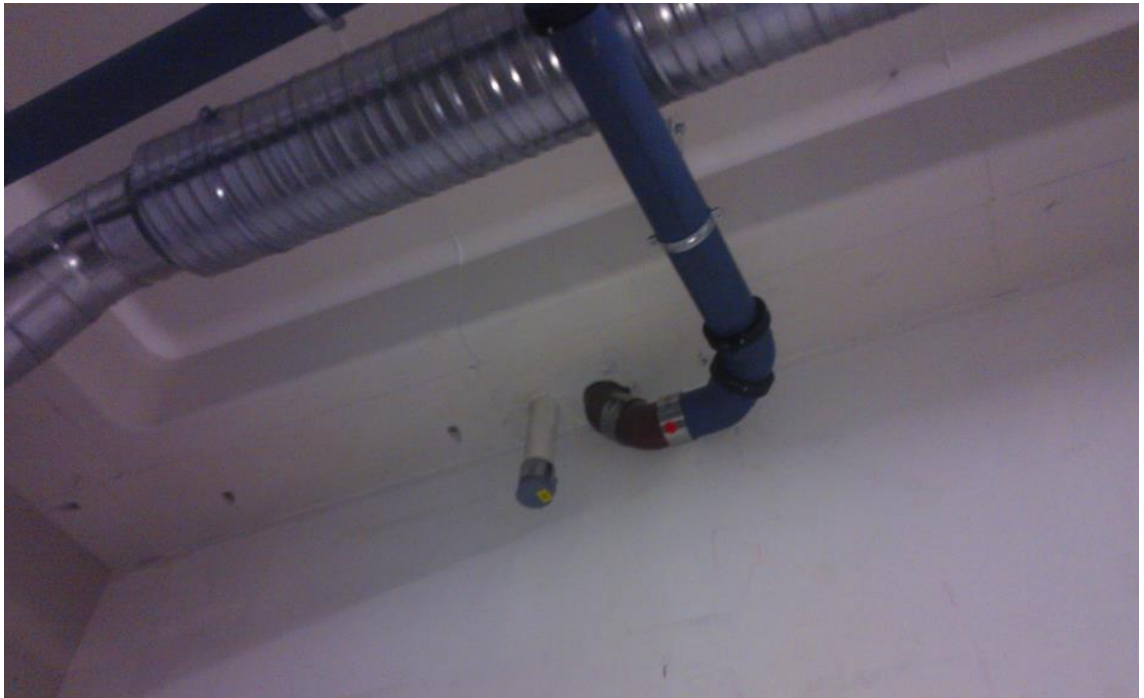
Kuva 8. Viemäriputki tulee holvin läpi valurautana ja jatkuu muovisena
