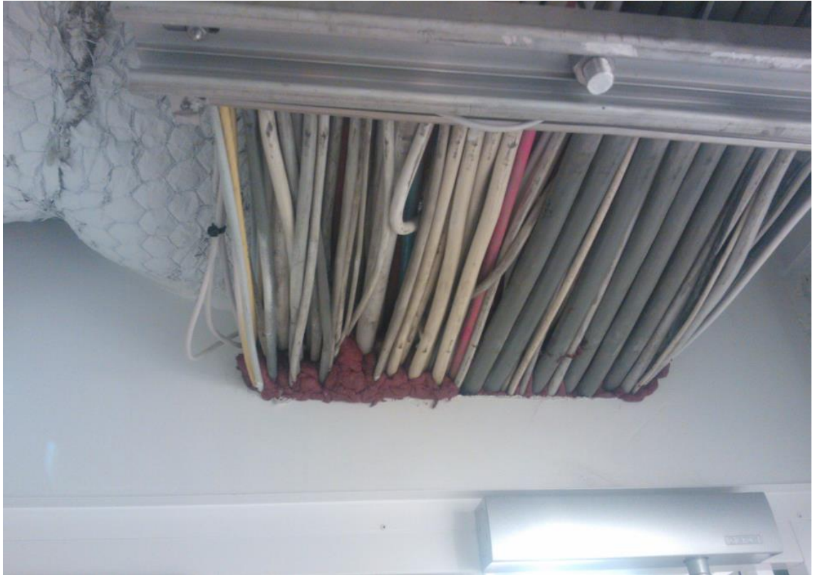
Kuva 13. Sähköläpivienti paisuvalla palokatkomassalla levyrakenteiseen seinään
