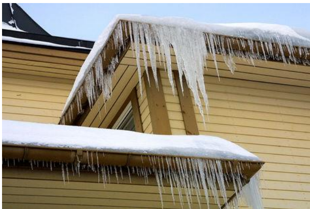
Kuva 11. Jääpuikkoja muodostunut ulkopuolelle [3.]
