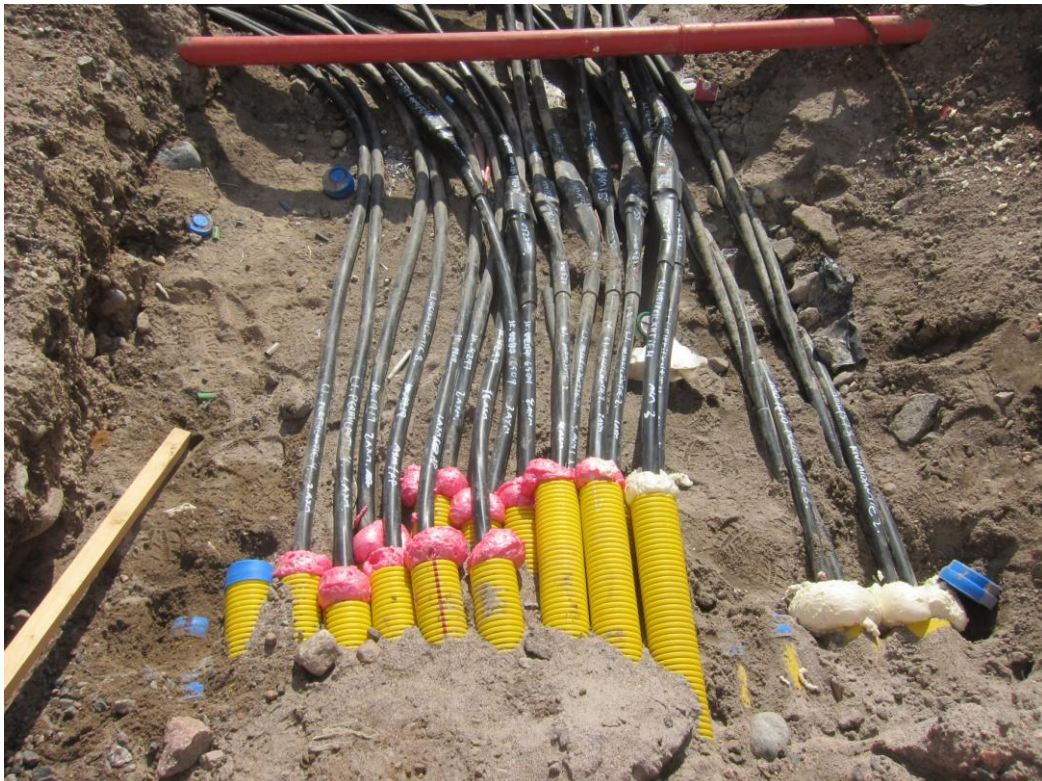
Kuva 21. Uudet kj- ja pj-kaapelit sekä niihin tehdyt jatkot
