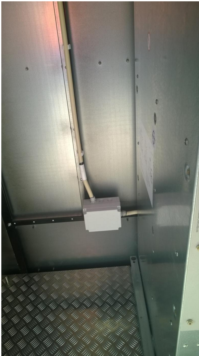
Kuva 14. Kj-kojeiston läheisyyteen seinälle asennettu WIMO-rasia
