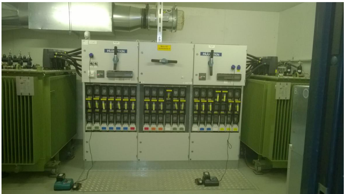
Kuva 18. Muuntajat, pj-kojeisto sekä valmiit välikaapeloinnit
