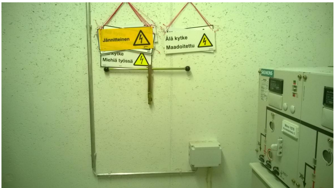
Kuva 22. Seinälle lisätyt kyltit, WIMO-rasia, sekä tunnukset kj-kojeistossa
