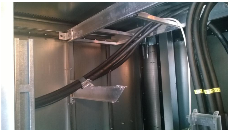
Kuva 6. Kohteeseen tehdyt kaapelihylly ja lisätuki kaapeleille
