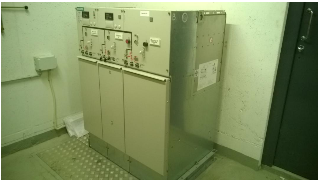
Kuva 20. Toinen Siemensin SF6-kaasulla varustetuista kj-kojeistoista
