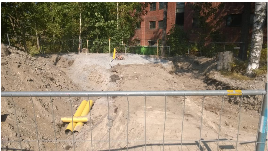
Kuva 2. Muuntamokoppia varten tasoitettu alue sekä rengasmaadoituksen kuparit
