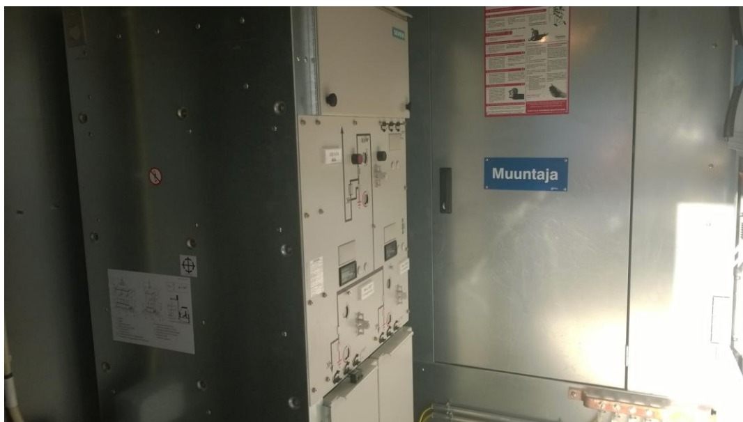
Kuva 7. Siemensin SF 6 -kaasulla varustettu kj-kojeisto
