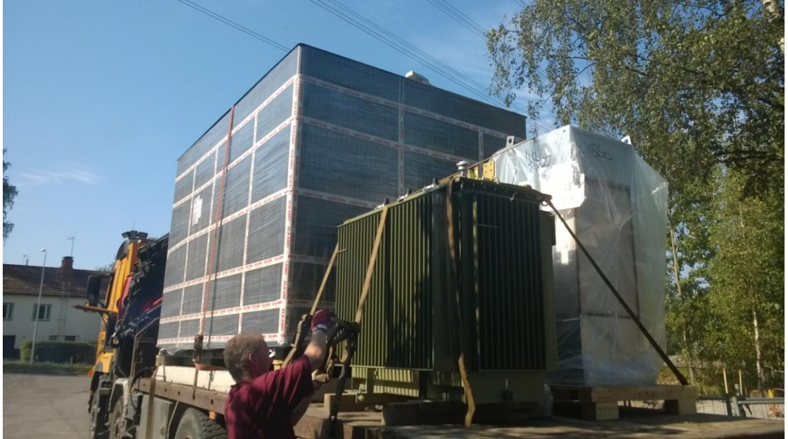
Kuva 3. Nostoauton paikalle tuomat muuntamokoppi, kj-kojeisto ja muuntaja
