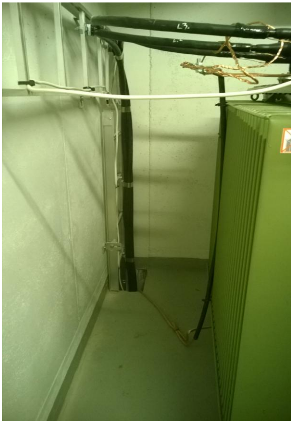
Kuva 17. Kj-välikaapelointi muuntajalta kj-kojeistolle
