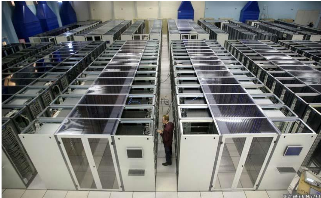
KUVA 1. CERN hiukkastutkimuslaitoksen konesali /3/
