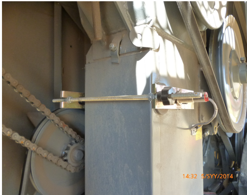
kuva 5. Anturi on asennettuna elevaattorin kylkeen
