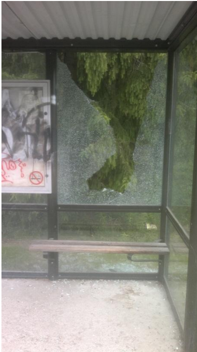
KUVA 4. Ilkivalta rasittaa kunnossapitoa
