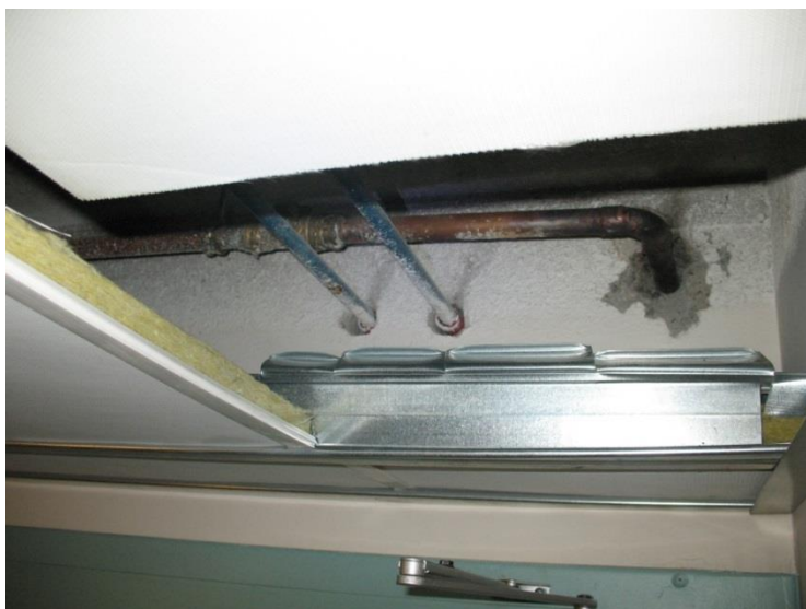
Kuva 8. C-osa. Läpivientejä osastoivassa seinässä (Hertteli 2014-09-24)
