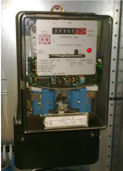
Kuva 3. Pääkeskuksen kWh-mittari Viikinmäen jätevedenpuhdistamolla.
