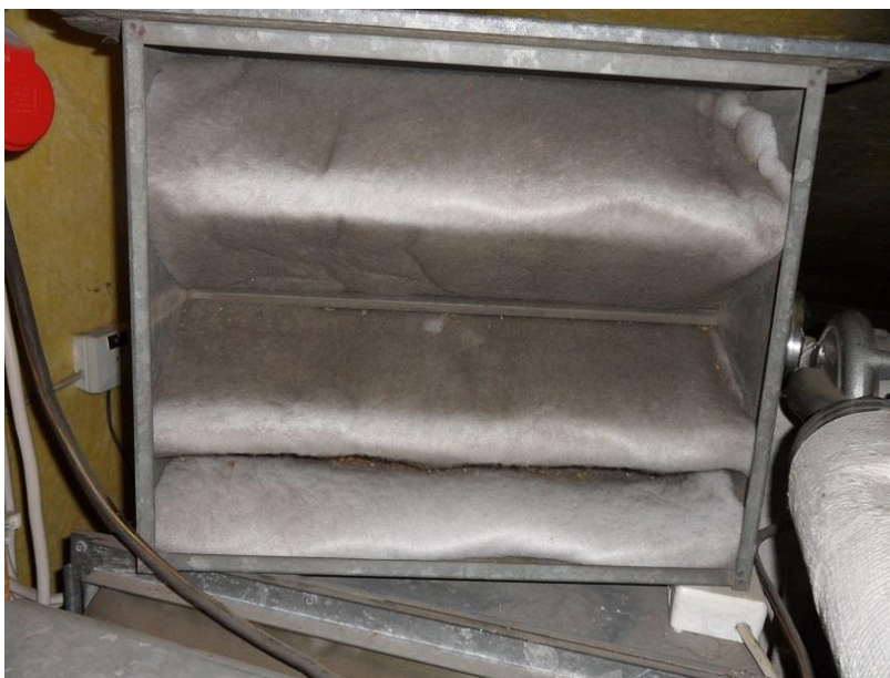
Kuva 13: Yhden tuloilmakoneen suodatin
