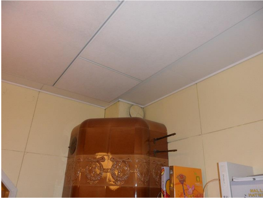
Kuva 20: Poistoilmaventtiili vanhan tulisijan hormissa
