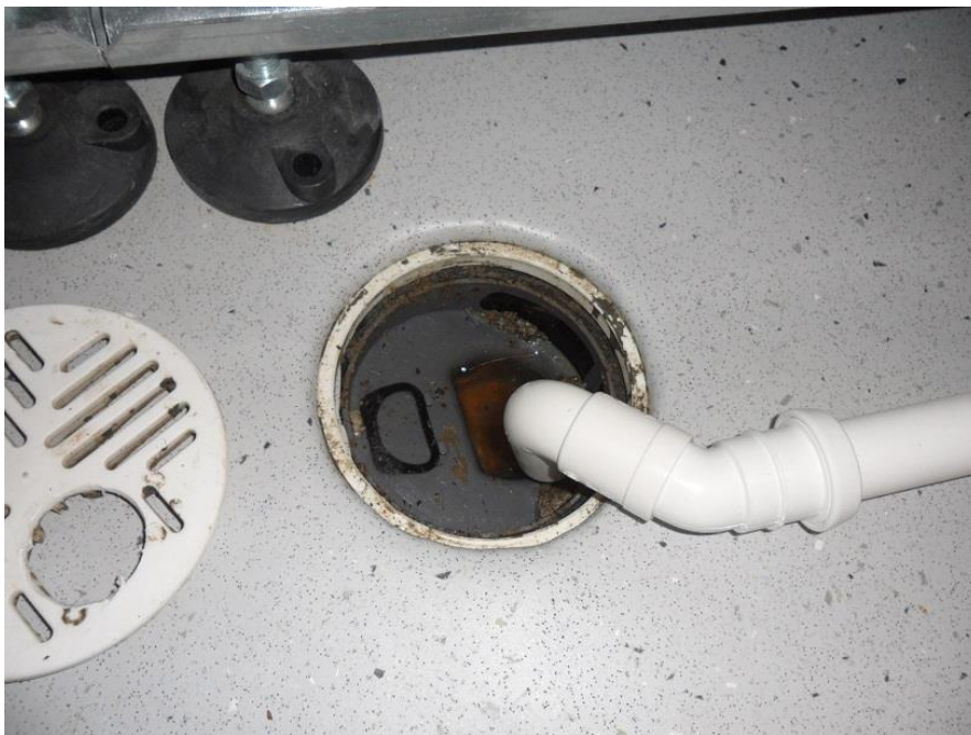
Kuva 10: Ilmanvaihtokoneen kondenssiveden viemäröinti
