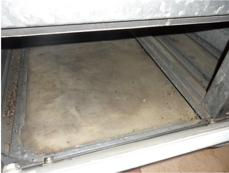
Kuva 18: Suodatinkammiossa oli roskaa
