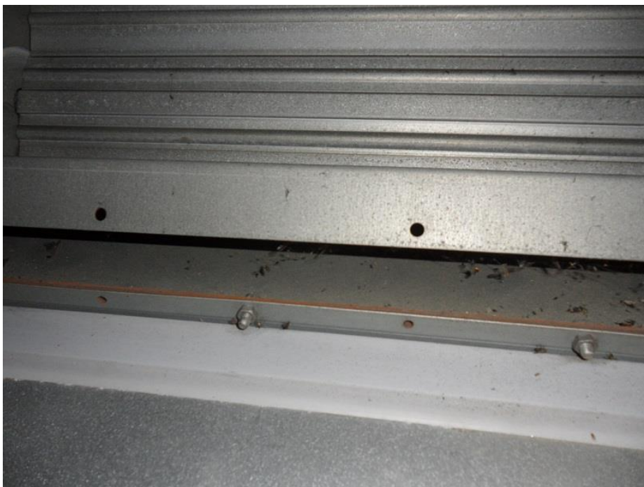
Kuva 6: Hyönteisiä ja hämähäkinseittiä tuloilmasuodattimien jälkeen
