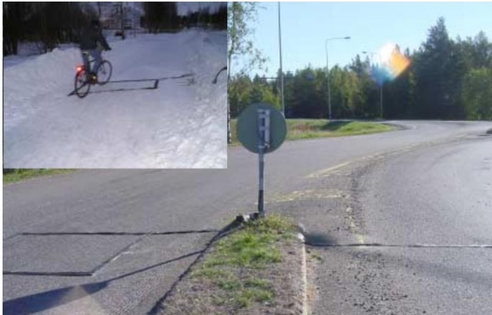
Kuva 3. Isommassa kuvassa ilmaisinsilmukat ovat pintaan asennettu vain ruuvaamalla. Itse laskentalaite on kiinnitetty liikenteen jakajamerkin taakse. (Liikenne- ja viestintäministeriö 2005.)
