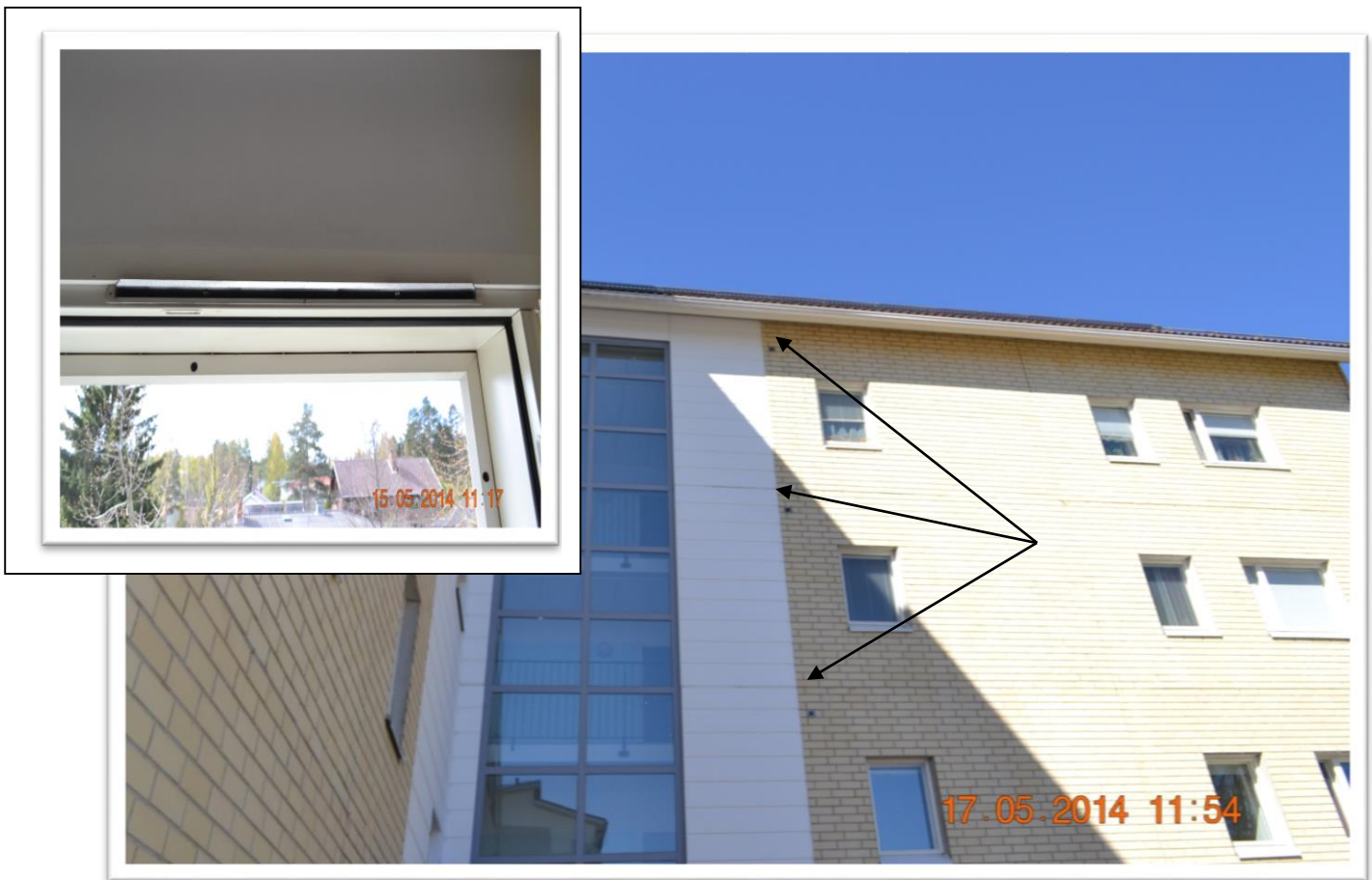
Kuva 6. Sandwich-elementeissä sekä ikkunakarmeissa on omat venttiilit tuloilmalle.
