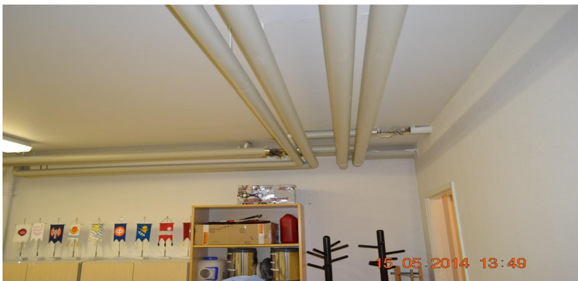
Kuva 11. Kellaritilojen lämpöjohtojen putkituksia.
