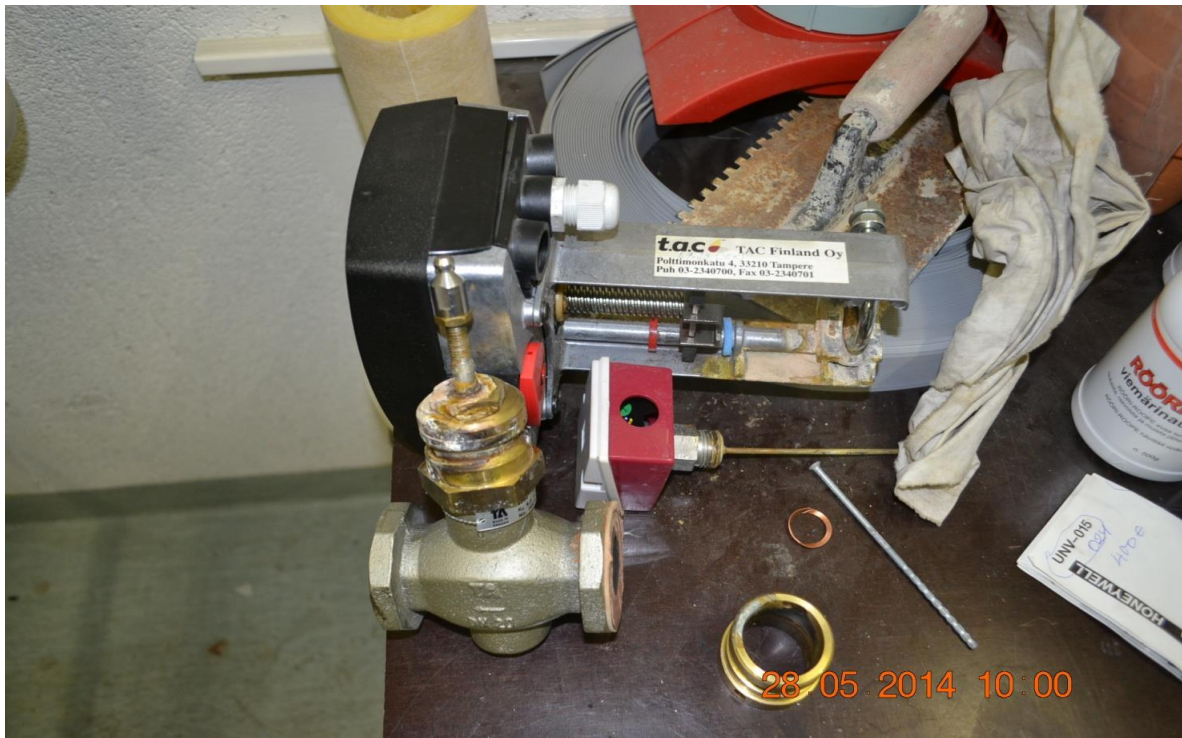
Kuva 26. Lämmönjakuhuoneessa; kaukolämpöverkkoon liitettävä vanha säätöventtiili jumiutunut.
