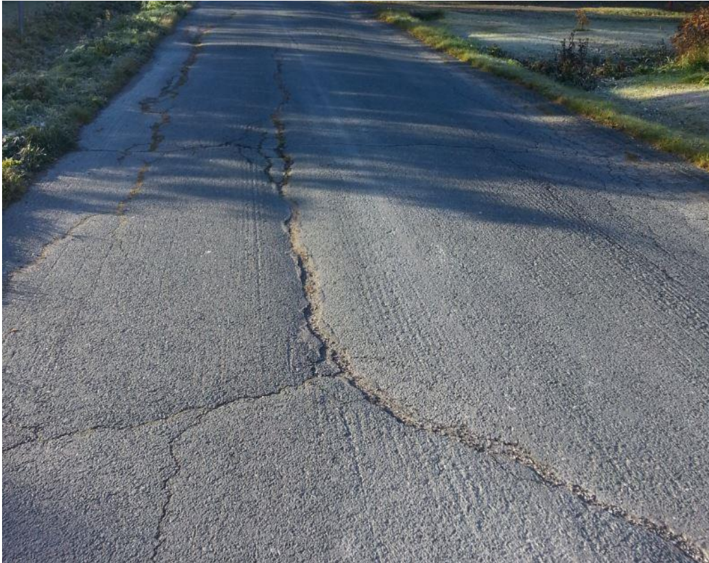
KUVA 9. Luokkaan 4 kuuluva katu, jossa on routavaurioita
