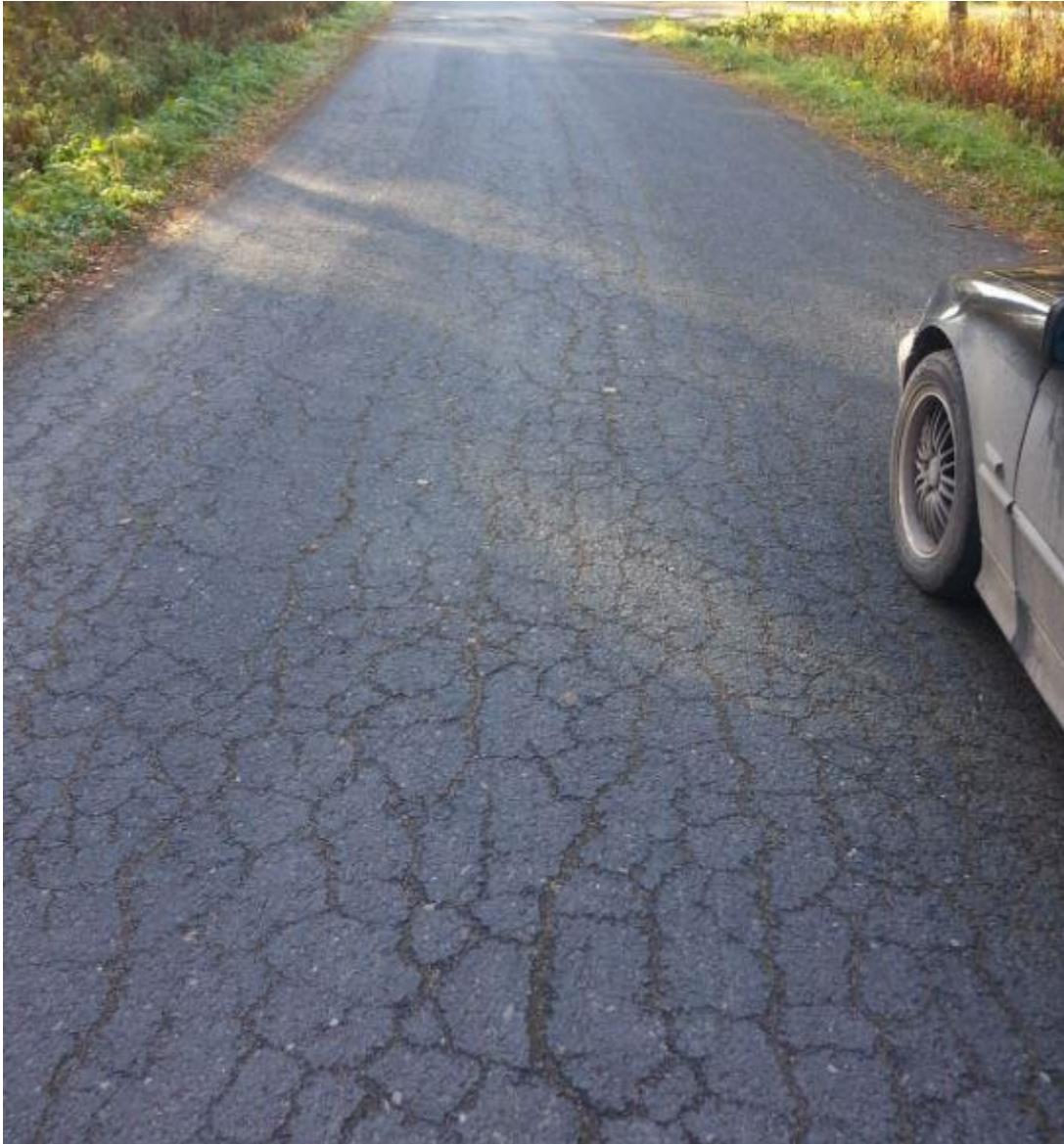
KUVA 8. Luokkaan 3 kuuluva katu, jossa on pitkälle edennyttä verkkohalkeilua päällysteessä
