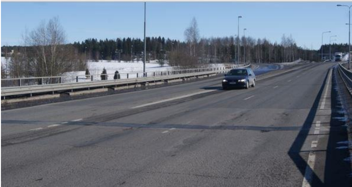
KUVA 7. Luokkaan 2 kuuluva katu, jossa on nastarengaskulutuksen aiheuttamia uria (Päällystystyöt 2014 Varsinais-Suomi ja Satakunta)
