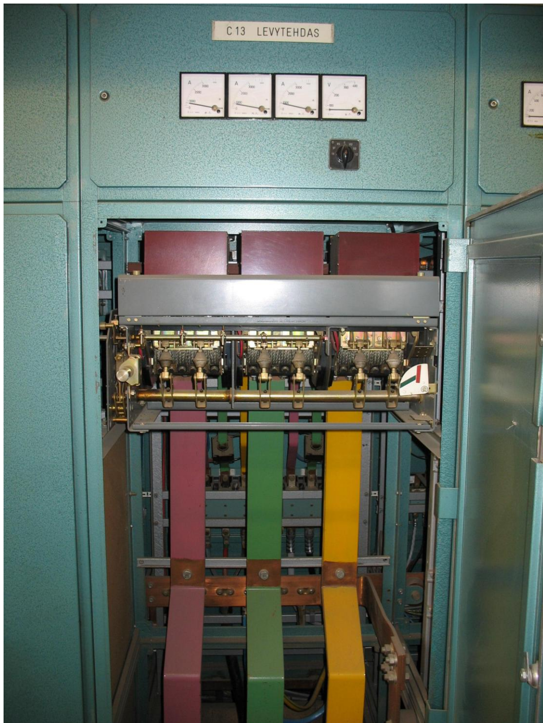
Kuva 8 C13 pääkeskus. Kiskot muuntajalta kulkevat ylhäällä piilossa.
