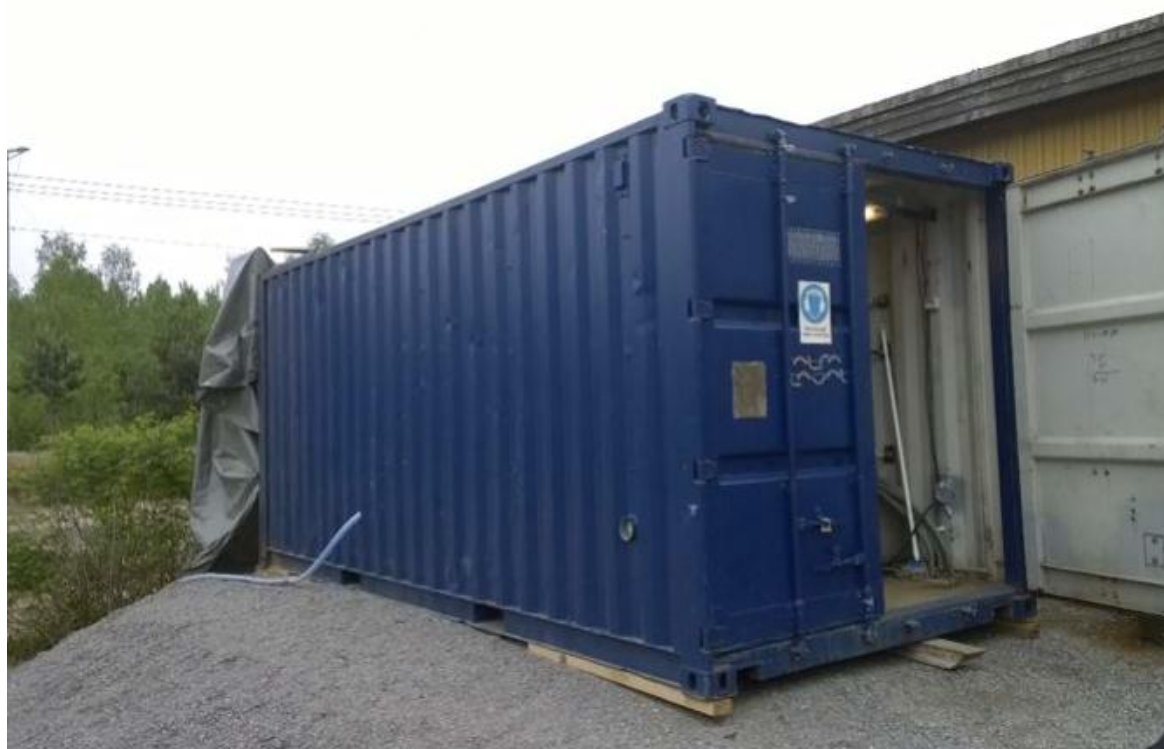
KUVA 17. Parikkalan jätevedenpuhdistamolla ollut MBR-pilot-kontti
