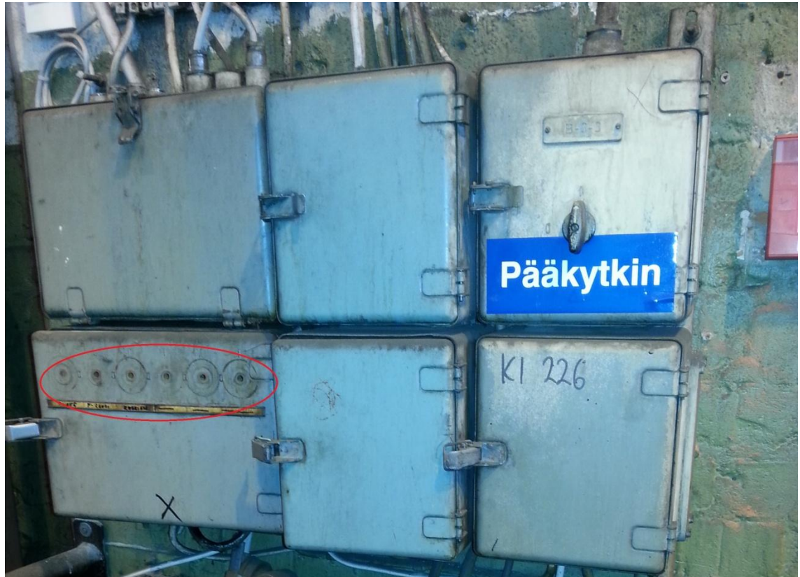
KUVA 6. Keskus B-3-3, jonka kannesta on poistettu nokkakytkimet
