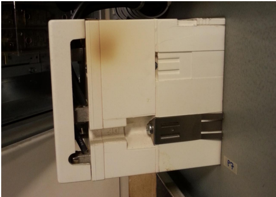
KUVA 4. Lämmön aiheuttama mittarin rikkoutuminen
