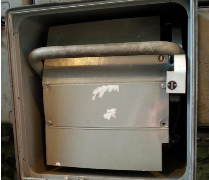
KUVA 10. Keskuksen B-15-2 pääkytkin.
