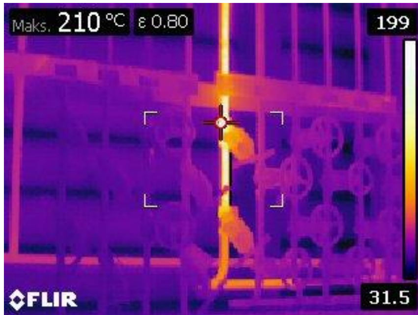
Kuva 18. Vuotavat höyryventtiilit soodakattilalla
