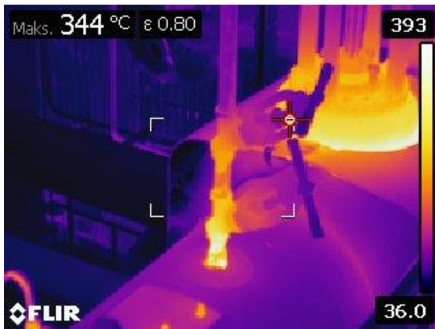
Kuva 19. Korkeapainehöyrylinjan pitävät venttiilit
