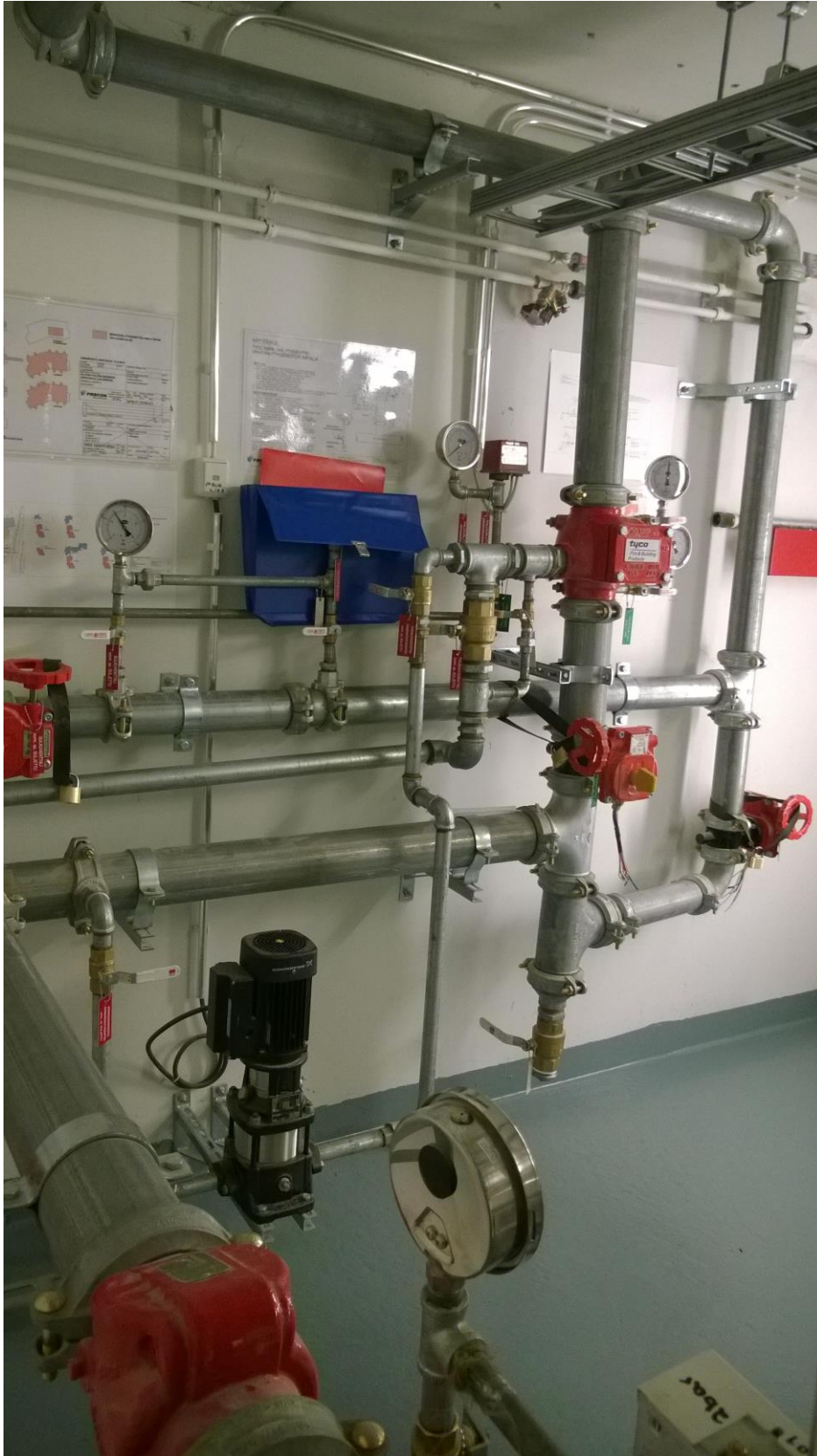
Kuva 6. Palvelukeskus Hopeakuun sprinklerikeskus, jonka seinällä ovat käyttöohjeet ja kytkentäkaavio.
