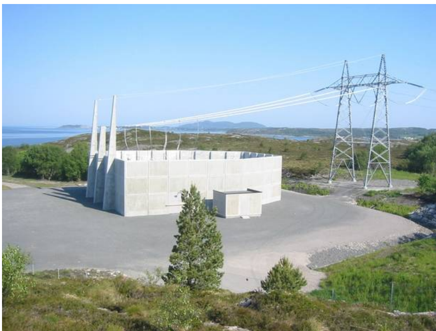
Figur 7. 420 kV övergångsstation mellan luftlinje och kabel, enligt klassificeringsgrunderna är detta en klass 3 station. (Sprenger, 2010).
