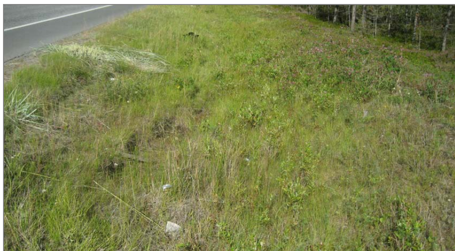
Kuva 9: Vaikeasti havaittavat ulosajon aiheuttamat jäljet luiskassa
