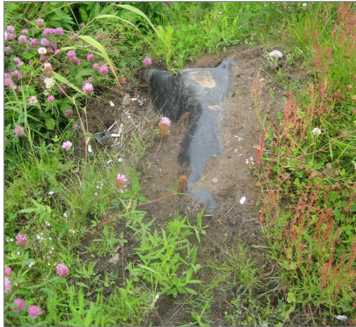
Kuva 6: Ulosajon aiheuttama vaurio muovikalvolla toteutetussa suojauksessa
