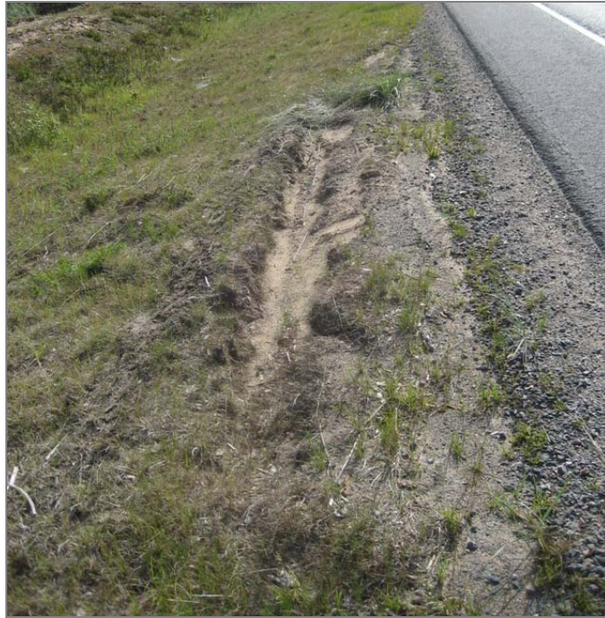
Kuva 8: Vaurio suojaverhouksessa sisäluiskan yläosassa
