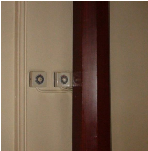
Kuva 12. Kirkkosalin lämmityksen lämpötilasäätimet (poissa/käytössä) etelänpuoleisella seinällä [10].
