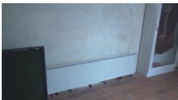
Kuva 25. Sähkölevypatteri asehuoneen seinällä [10].
