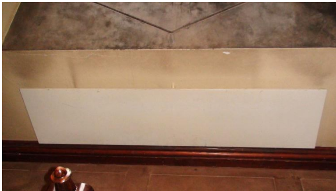
Kuva 10. Sähköinen levypatteri kirkkosalin ulkoseinällä [10].
