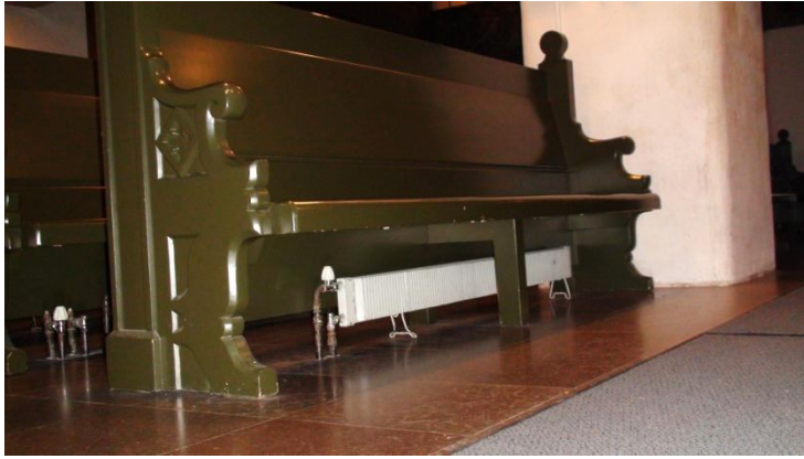
Kuva 14. Lämmityspatterit kirkkosalin penkin alla, takana näkyy lattialämmityslenkin sulkuventtiili [10].
