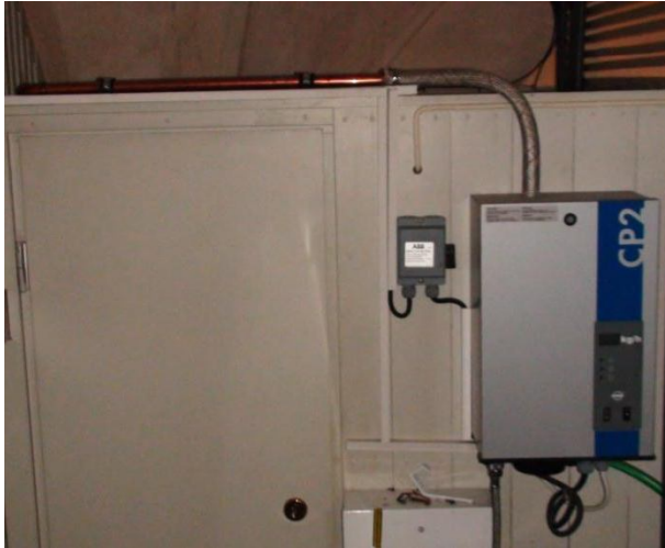
Kuva 15. Urkujen ilmankostutin, urut vieressä kuvassa vasemmalla [10].
