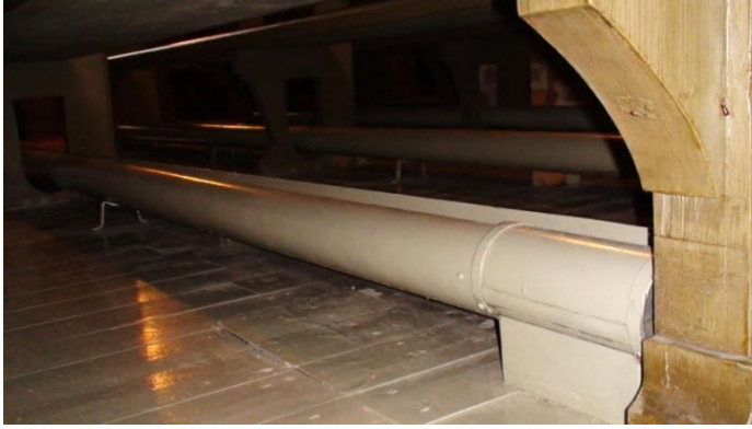
Kuva 20. Sähköputkipatteri kirkkosalin penkin alla [10].
