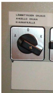
Kuva 26. Lämmityksen käyttökytkin ohjauskeskuksessa [10].
