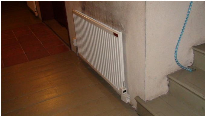
Kuva 22. Öljytäytteinen sähkölevypatteri kirkkosalissa [10].
