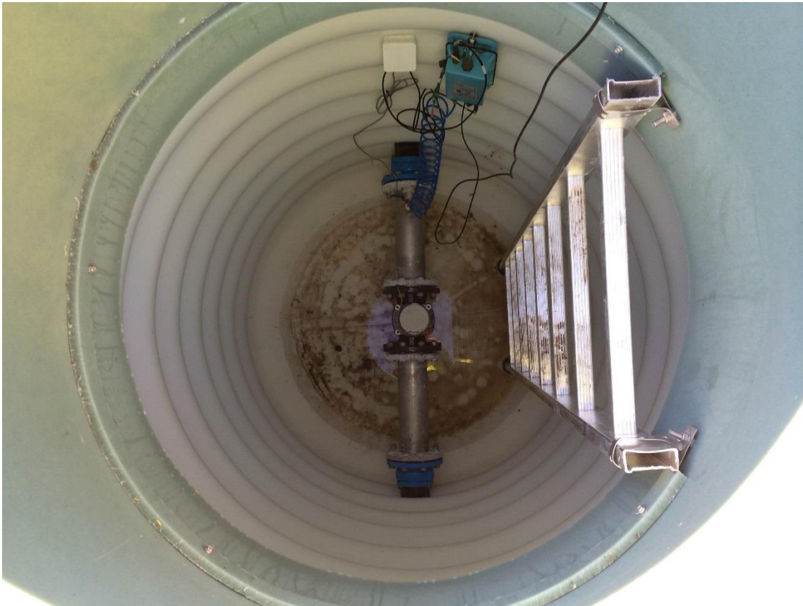
Figur 8. Fotografi inifrån en befintlig mätbrunn. Mekanisk mätare i mitten, den blåa boxen samlar data och skickar till övervakningscentret, svarta kabeln som går upp är antennkabeln. Rasmus Lönnberg 2014.
