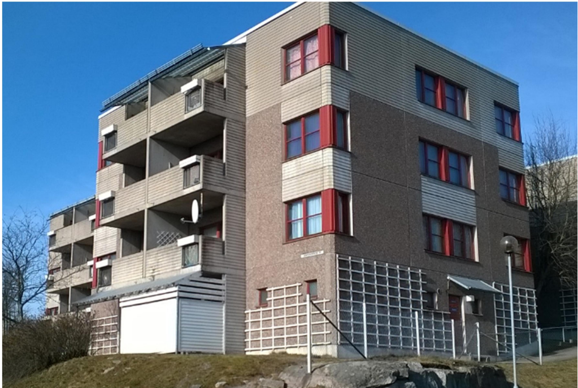
Kuva 5. Betonijulkisivun uritetun osan pinnoite tummunut. Alaosa on tehty pesubetonipinnalla.
