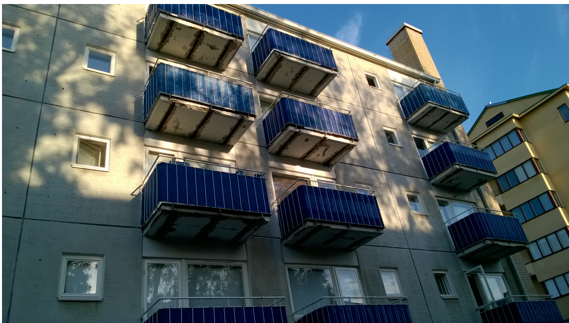
Kuva 8. Parvekkeiden alapinnat on piikattu auki.
