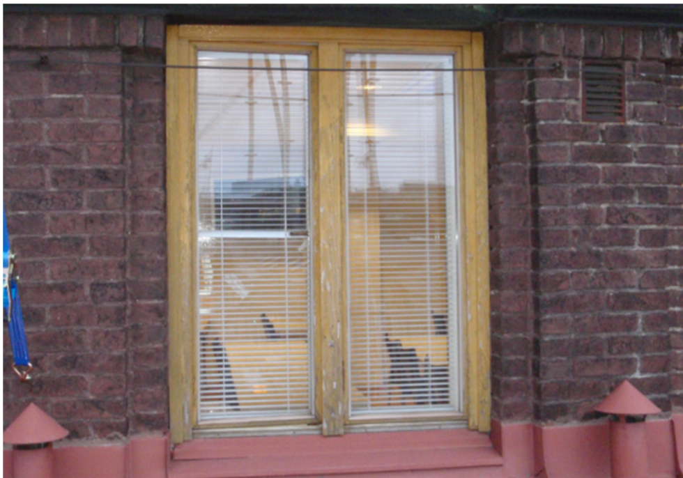
Kuva 9. Korjausurakan yhteydessä vaihdettava ikkuna.
