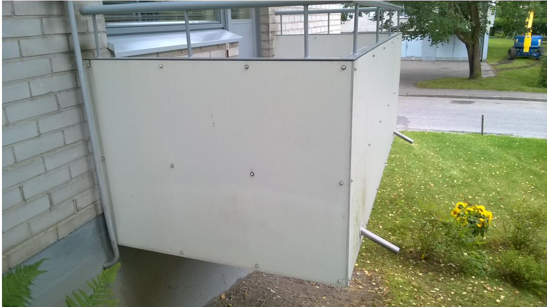
Kuva 16. Konalan takuuajan jälkeen vaurioitunut parveke.
