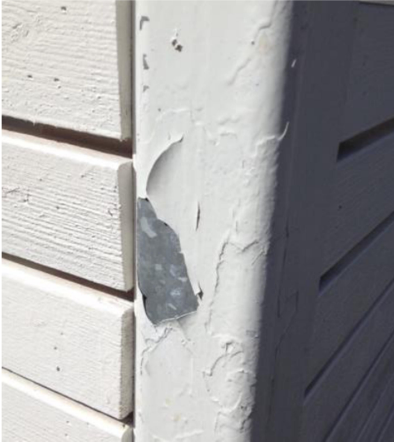
Kuva 11. Maali on irronnut alustastaan.
