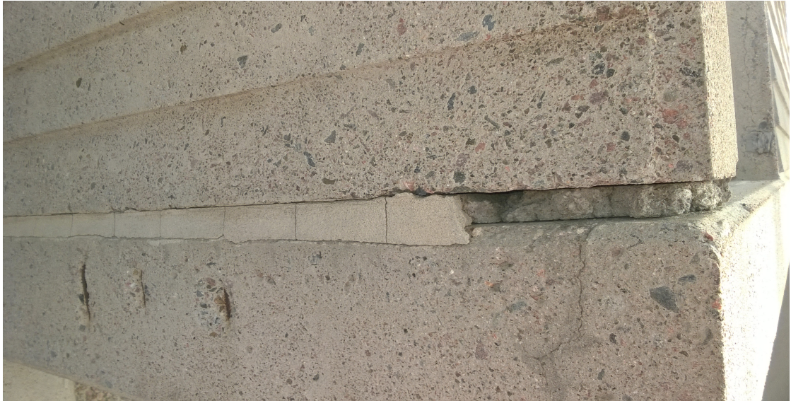
Kuva 4. Raudoitusten ruostuminen on aiheuttanut vaurioita. Lisäksi saumalaasti on rapautunut ja murentunut pois.
