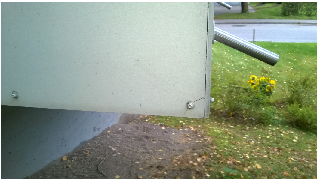
Kuva 17. Konalan kohteen uusitun parvekkeen kuitusementtilevyn halkeama lähempää.
