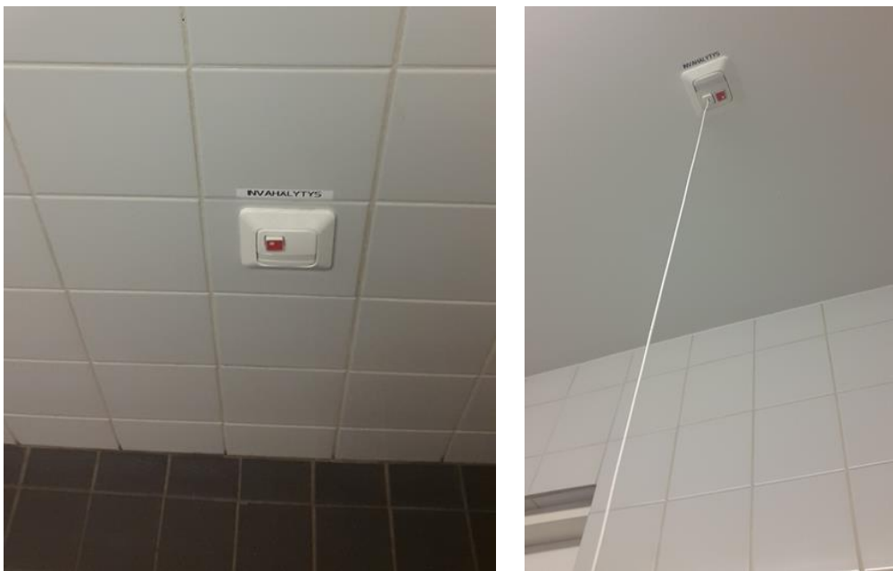
Kuva 28–29. Hälytyskutsu painike lattianrajassa ja vetonauha katossa (kuvannut Niina Kuusisto).
