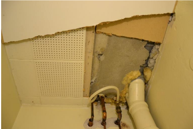
Kuvio 18. Kansalaisopiston wc:n katossa vaurio putkikorjauksista
