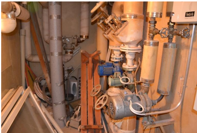
Kuvio 28. Alkuperäisiä kiertovesipumppuja
