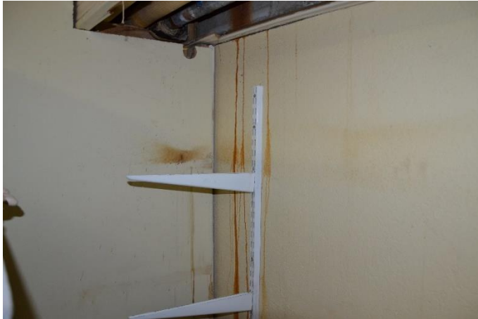
Kuvio 21. Kansalaisopiston varastotilassa putkivuodoista vaurioita
