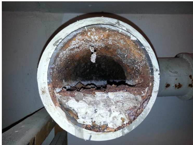
Kuva 2. Katavkarin vanha viemäriputki.
