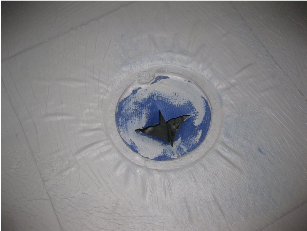
Kuvio 11. Virheellisesti asennettu kaivoläpivientikappale.
