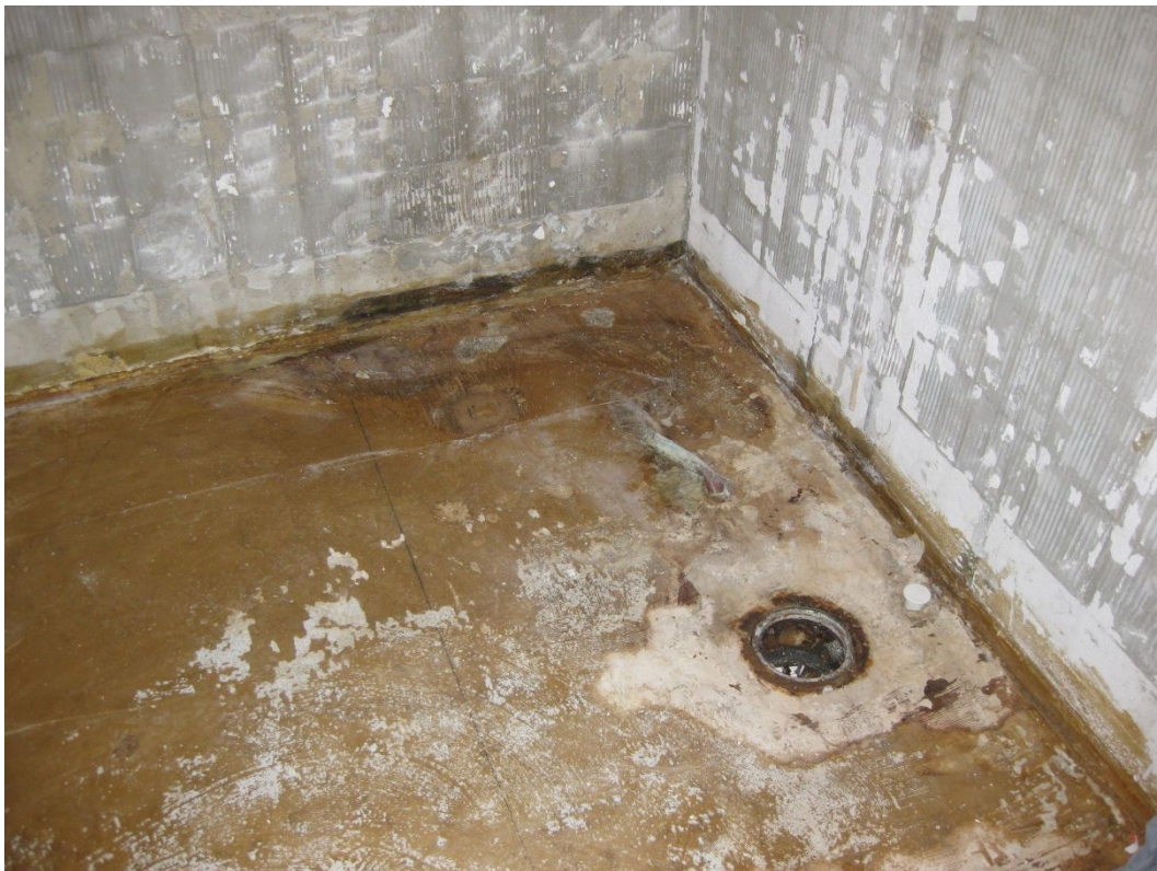
Kuvio 9. Kylpyhuoneen lattiassa laaja mikrobi- ja kosteusvaurio.
