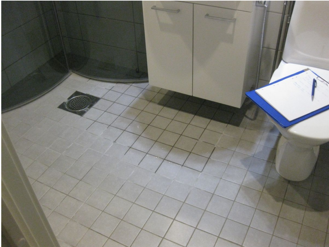
Kuvio 2. Esimerkkikuva lammikoitumisesta valvontakohteessa.
