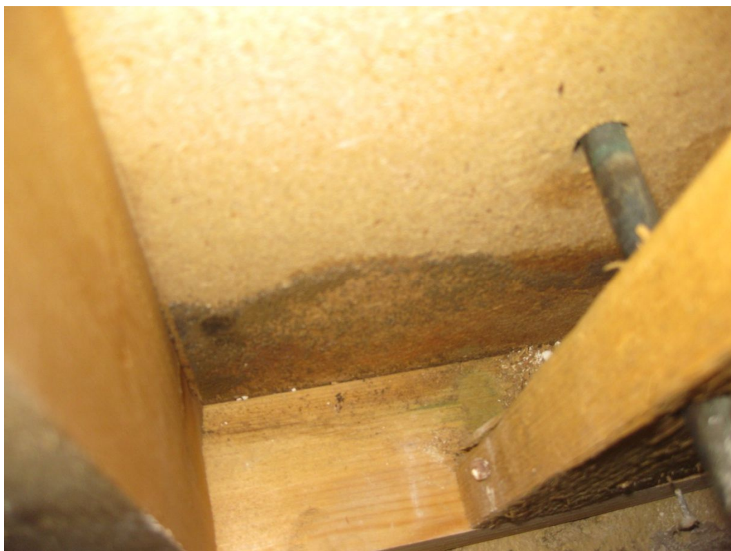
Kuvio 4. Mikrobikasvustoa puurunkoisen väliseinän levytyksessä.
