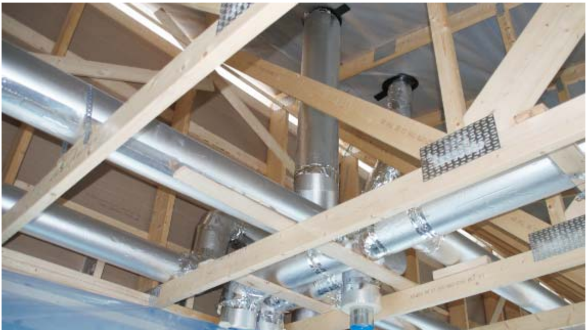
Kuva 32. BetterPipe-kanavistoa ullakolla (kohde A).
