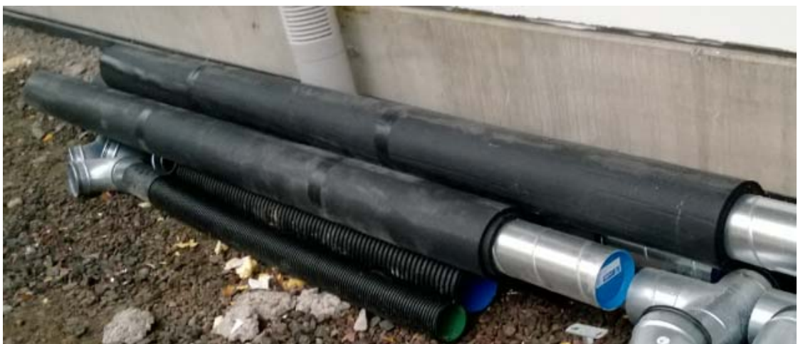
Kuva 34. Valmiiksi eristettyjä raitis- ja jäteilmakanavia odottamassa työmaalla asennusta. Eristys on tehty 13 mm:n solukumimatosta kahtena limitettynä kerroksena.
