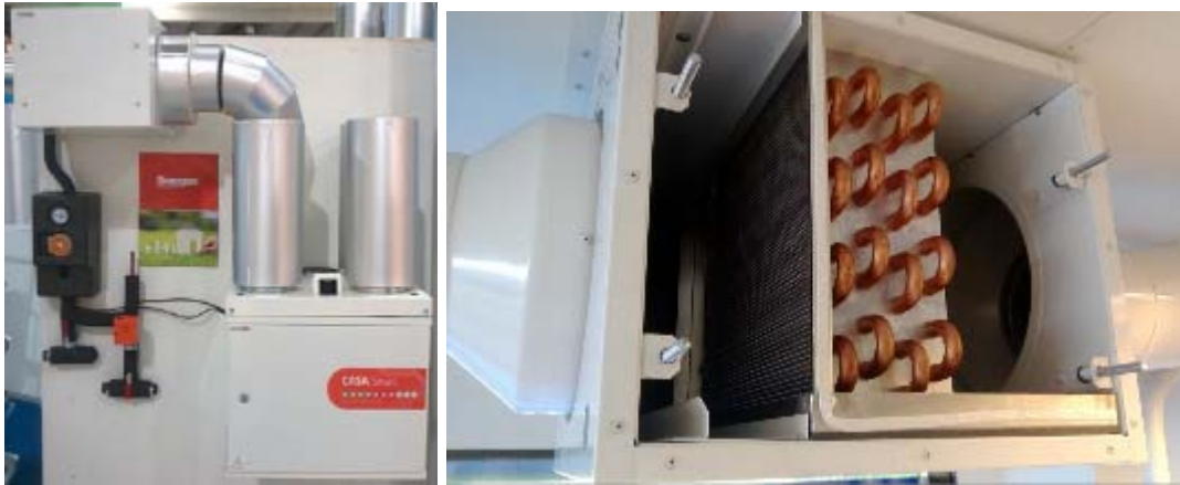
Kuvat 8 ja 9. Ilmanvaihtokoneen ohjauksella lämpötilaa säätävä viilennyspatterikytkentä. Kanavapatterina Swegon Casa \varnothing 250 mm, joka oli mittauskohteessa B. Oikealla kanavapatteri Swegon Casa etulevy avattuna.
