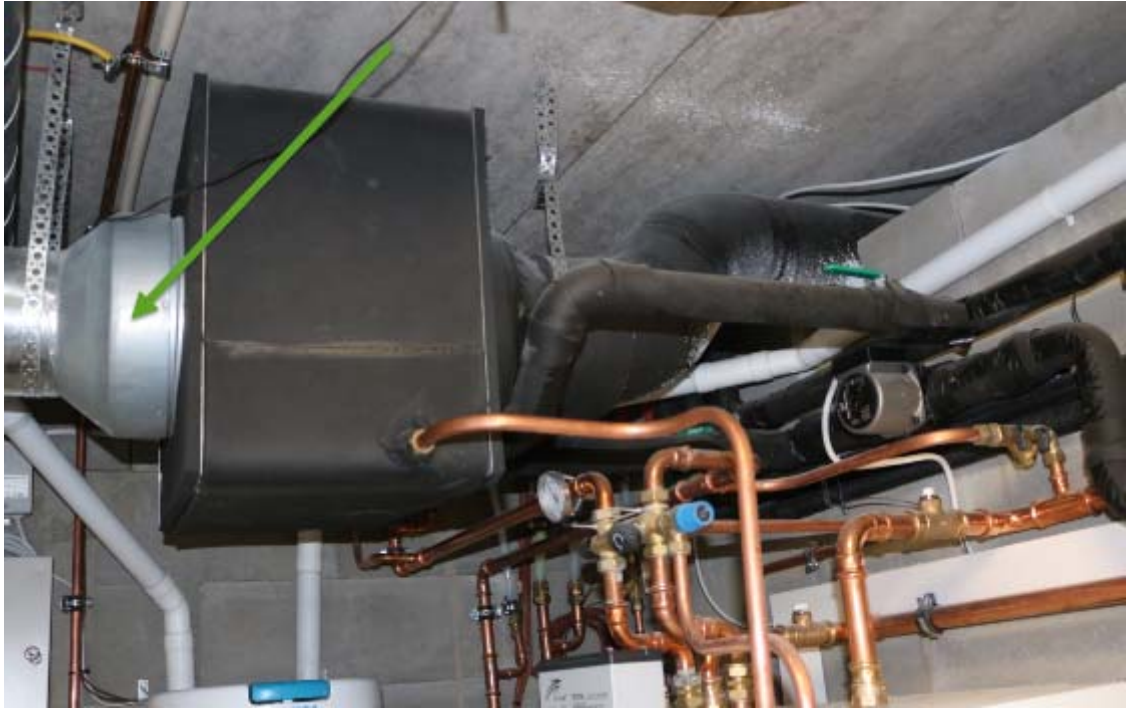
Kuva 35. Hyvin eristetty viilennyspatteri (Veab CWK 250). Viilennyspatterille tuleva tuloilmakanava (vihreä nuoli) on eristämätön ja patterilta alkaen kondenssieristetty.
