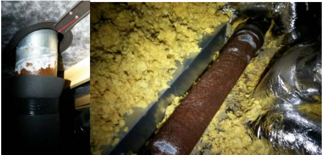
Kuva 62 ja 63. Poistoilmalämpöpumpun 6 vuotta käytössä ollut vanha jäteilmakanava.
