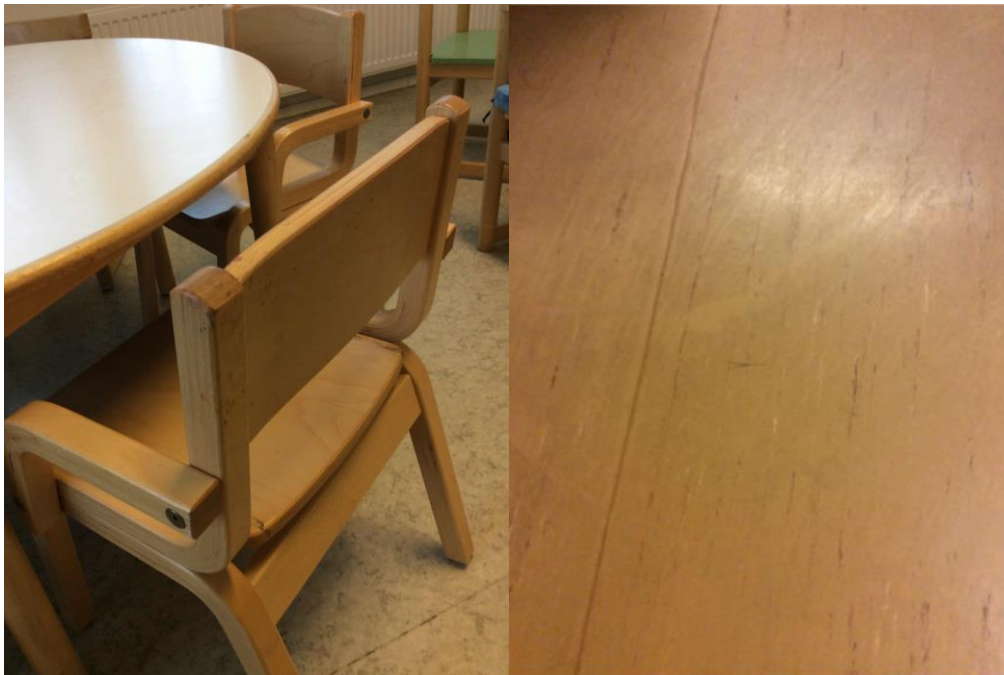
KUVA 12. Pintalikkaa ruokailutilan kalusteissa ja käytävän lattiassa
