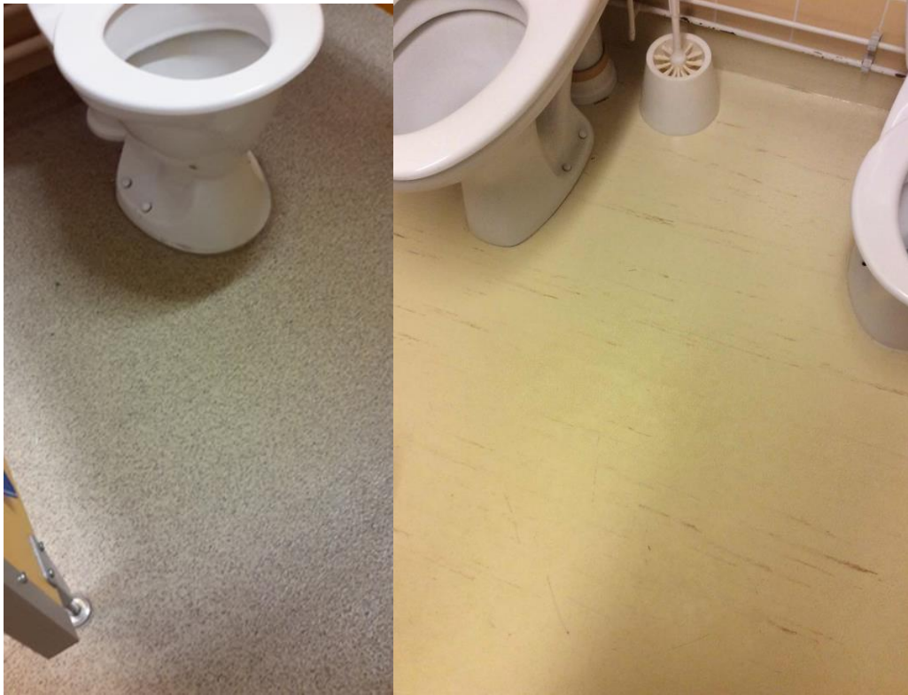
KUVA 9. Pintalikaa saniteettitilojen lattioissa ja eritetahra wc-istuimessa
