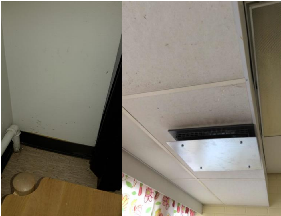
KUVA 11. Poikkeamia seinässä ja katossa
