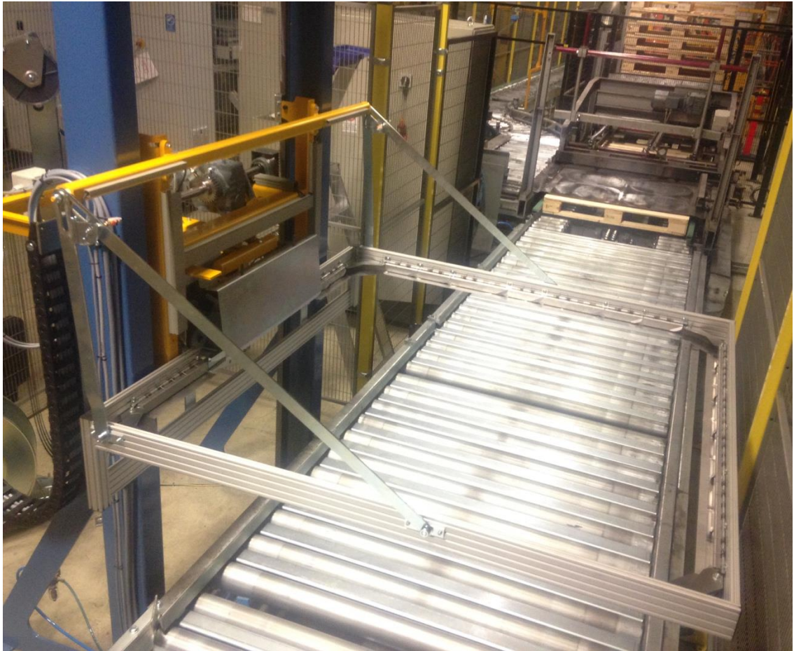
Kuva 3. Alumiiniprofiilinen vannetuskehä. Sinisten runkopalkkien välissä sijaitsee saumausyksikkö.
