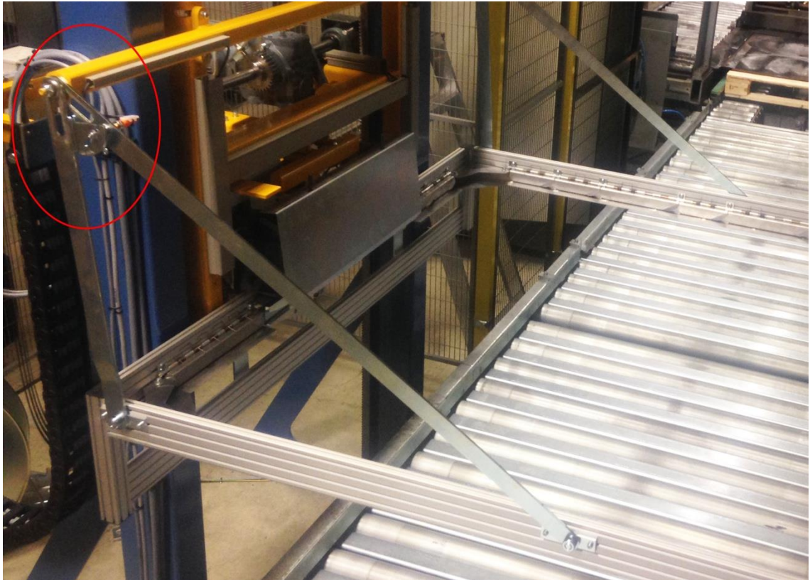
Kuva 9. Vannetuskehän kulmatuen yläosan liukuvara ympyröitynä.
