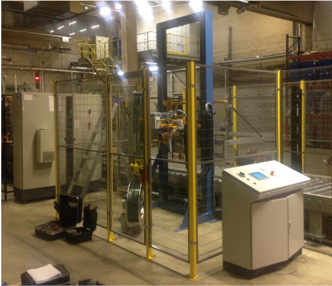
Kuva 12. Turva-aidattu vannetuskone ja vannekelain. Ohjausyksikkö jäi ulkopuolelle.
