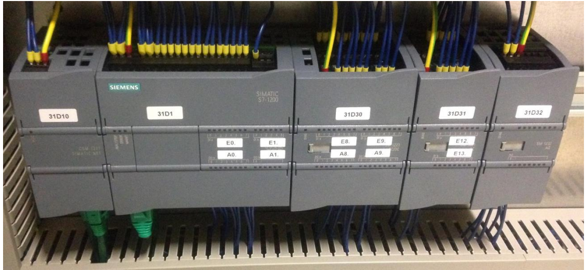
Kuva 5. Koneen ohjauksesta vastaa Siemensin Simatic S7-1200 -logiikka laajennusmoduuleineen.
