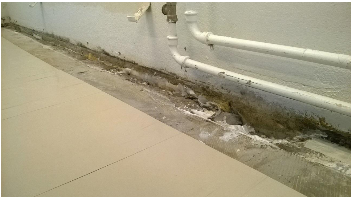
Kuva 2. Lattian ja seinän rajapinnan rako.
