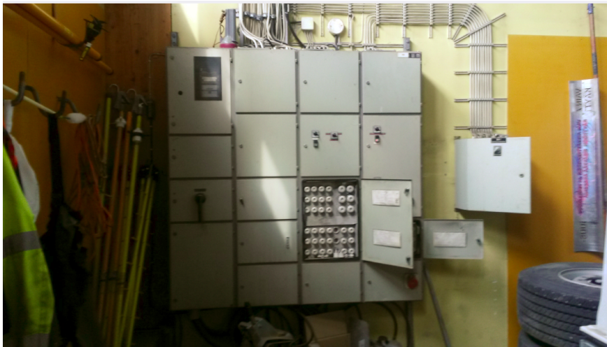
Kuva 4. Varastorakennuksen pääkeskuksen nykyiset asennukset
