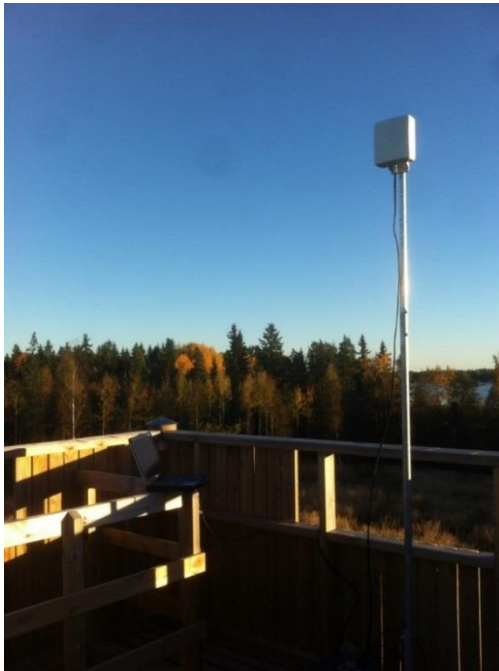
Kuva 17. Mittaus Littoistenjärven lintutornissa. Kuvan antenni WMM8G.
