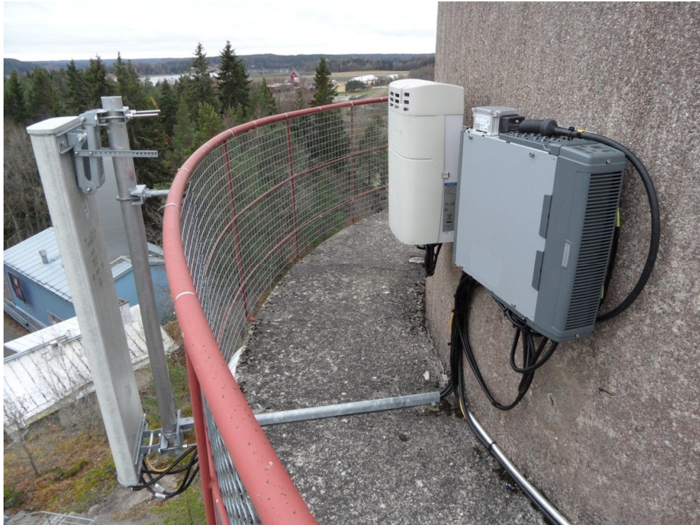
Kuva 3 Radioyksiköiden asennus kiinteistöön.
