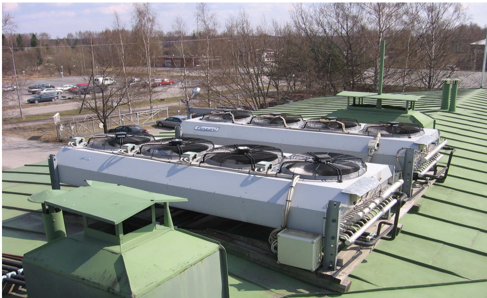
Kuva 5.1 Fincoilin lauhduttimet OY KWH Pipe Ab:n Ulvilan tehtaan katolla.
