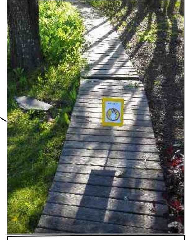
Lammen ja uoman välisessä maakaistaleessa on päällystetty reitti, joka on huonossa kunnossa. Reitillä kulkeminen on estetty kieltomerkein.
