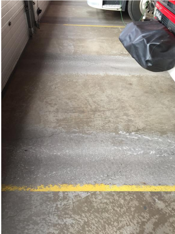
Kuva 30. Kalustohallin kulunut lattiapinta.
