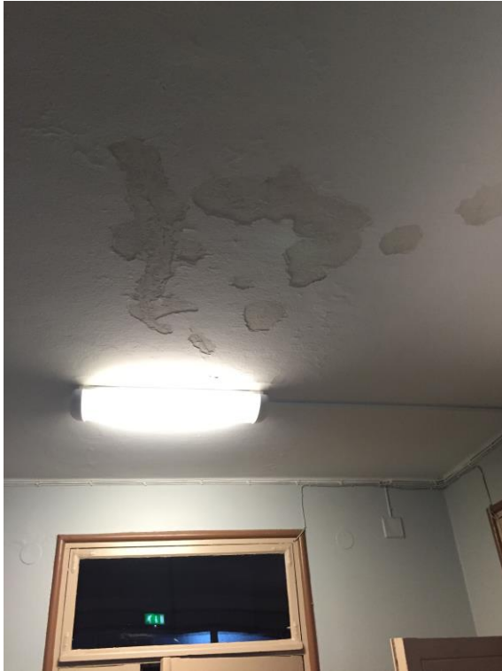
Kuva 24. Katon irronnutta maalia.
