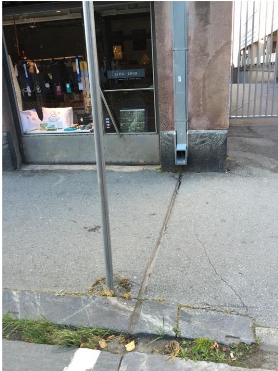
Kuva 2. Kadun puoleinen syöksytorvi.
