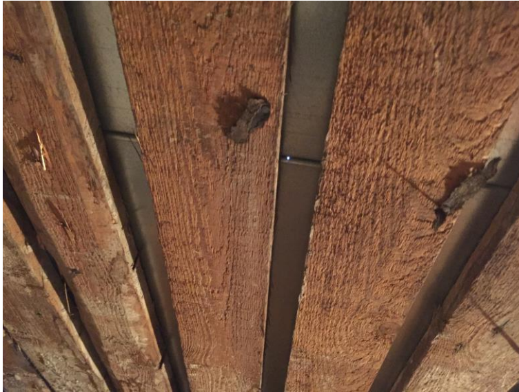
Kuva 19. Reikä katteen saumassa.
