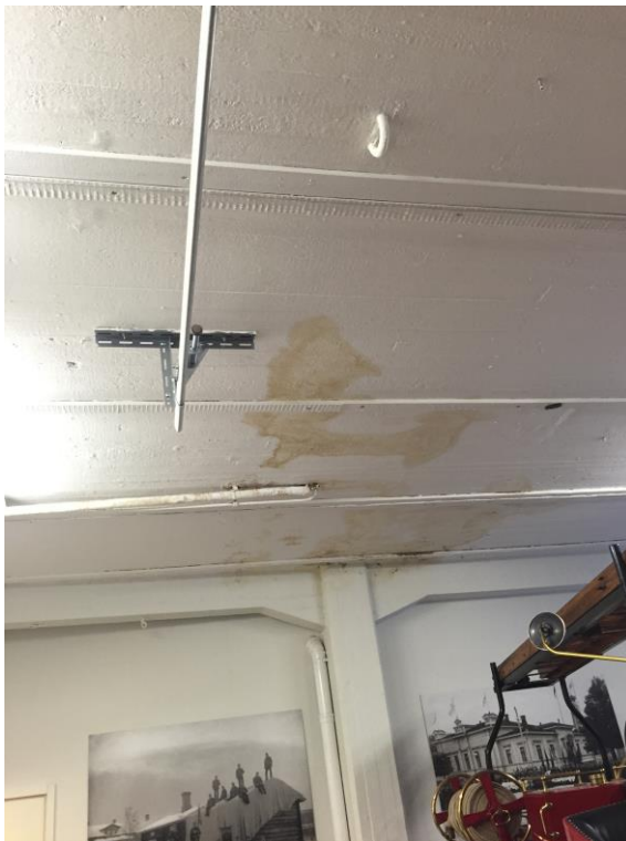
Kuva 8. VPK:n liiketilan yläpuolisessa välipohjassa oleva kosteusvaurio.
