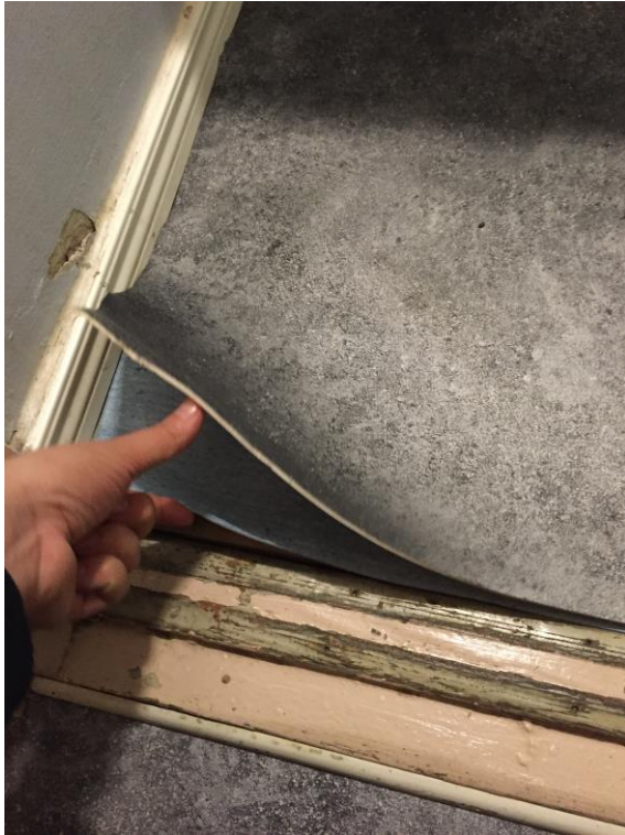
Kuva 28. Vessan irronnut kaksinkertainen lattiamatto.
