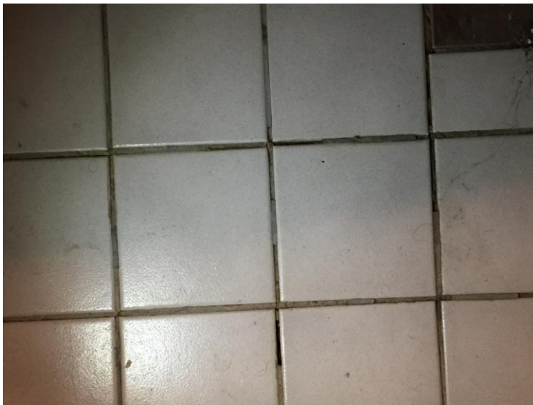
Kuva 27. Pesuhuoneen irronnut saumaus.
