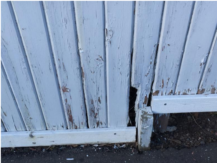
Kuva 5. Teräsrunkoisen puuaidan lahonnut verhouslauta.
