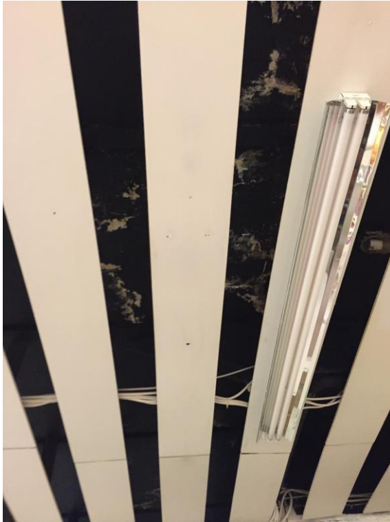
Kuva 9. Taitokeskuksen yläpuolisessa välipohjassa oleva kosteusvaurio.
