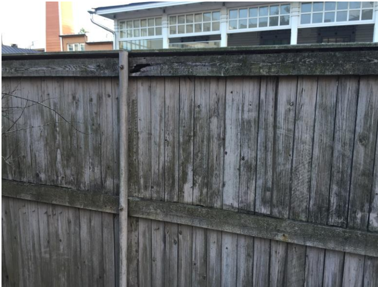
Kuva 4. Teräsrunkoisen puuaidan lahonnut takapuoli.
