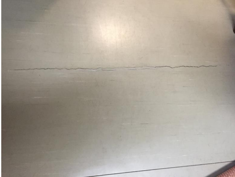
Kuva 29. Naisosaston muovimaton halkeama.
