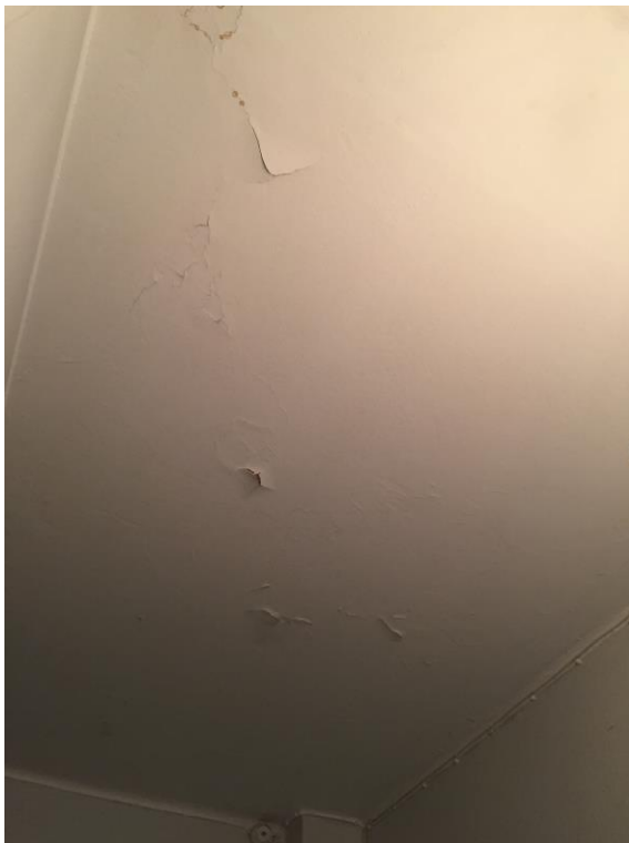
Kuva 10. Toisen kerroksen yläpuolisen välipohjan kosteusvaurio.
